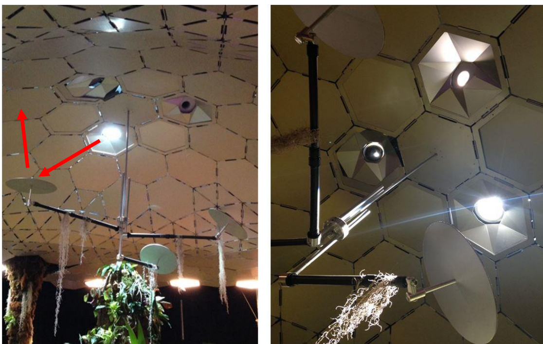
Figura 50 – Imagens do forro reflexivo, das luminárias solares (conectadas aos cabos de fibra óptica que vêm da cobertura) e dos refletores internos que serão utilizados no futuro parque subterrâneo.
