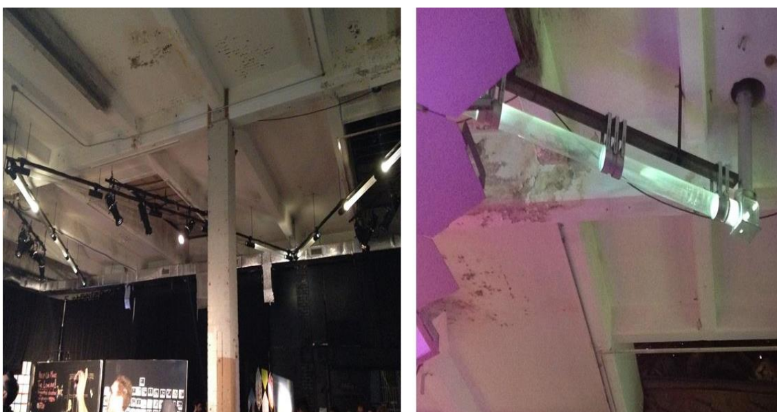
Figura 52 - Sistema de iluminação complementar com dutos transparentes que transportam a luz ao longo do seu comprimento e dissipam-na para o ambiente.
