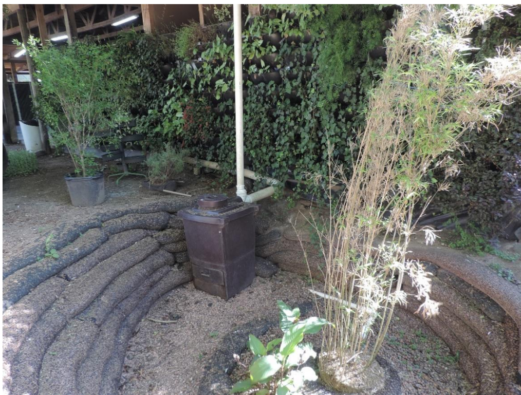
Figura 11 - Área da Wetland construída do Ecoesgoto, onde ocorre tratamento completo dos resíduos sanitários.
