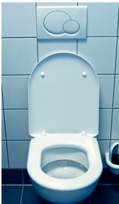
Figura 3 - Bacia sanitária de válvula.
