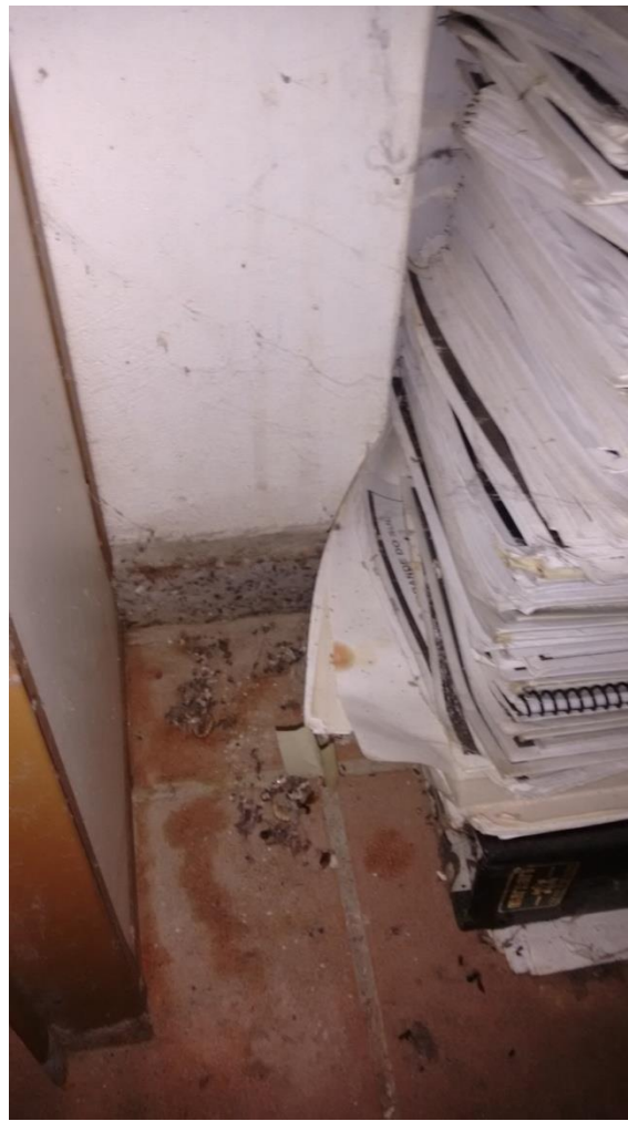
Figura 2 SALA DEPÓSITO - documentação empilhada diretamente no chão junto de resíduos
