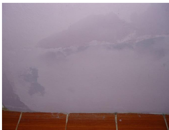
Figura 79 – Parede com presença de umidade no Loteamento Chapéu do Sol
