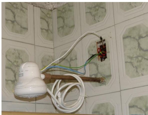
Figura 173 – Instalação do chuveiro com emendas expostas no Loteamento Chapéu do Sol
