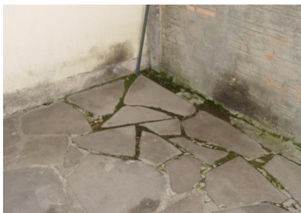
Figura 72 – Piso solto e com presença de umidade no Loteamento Chapéu do Sol
