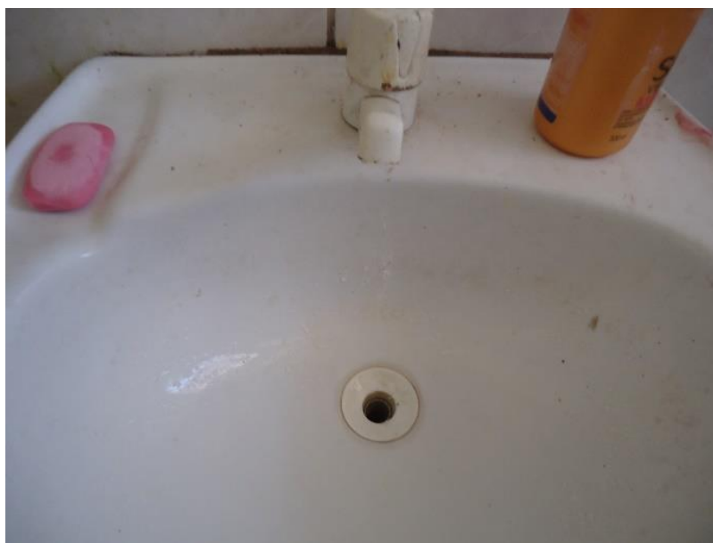
Figura 162 – Torneira não fecha e a água corre sempre no Residencial Nova Chocolate
