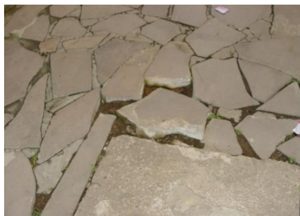
Figura 73 - Piso solto e com presença de umidade no Loteamento Chapéu do Sol
