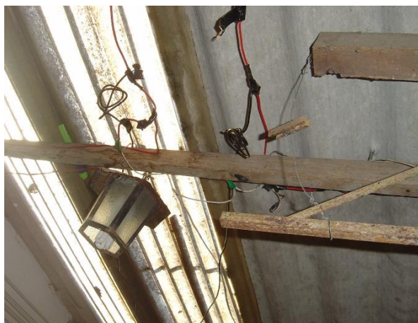
Figura 179 – Instalação elétrica da unidade totalmente exposta no Loteamento Chapéu do Sol
