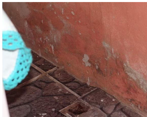
Figura 129 – Pintura manchada e descascada no Loteamento Chapéu do Sol
