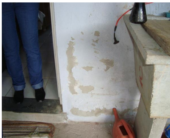
Figura 120 – Pintura descascada no Residencial Nova Chocolateão
