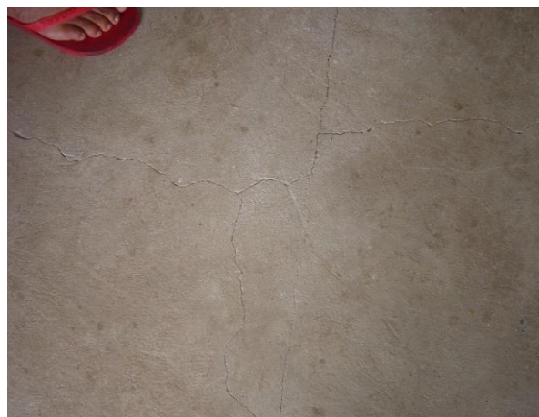
Figura 75 - Piso fissurado no loteamento São Guilherme
