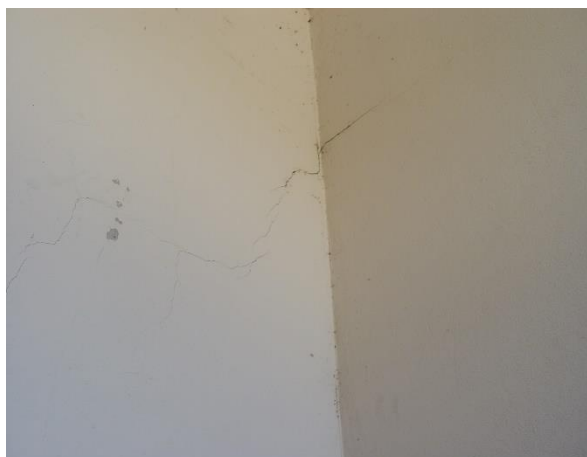
Figura 88 – Parede com fissuras no Loteamento São Guilherme
