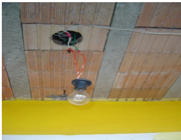
Figura 171 – Lâmpada fixada apenas pelos fios no Loteamento Chapéu do Sol
