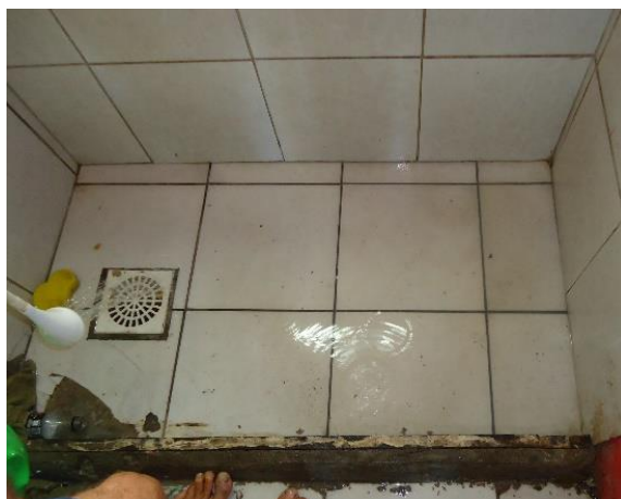
Figura 76 – Piso com caimento ao contrário no Residencial Nova Chocolateão
