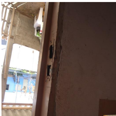
Figura 140 – Fechadura danificada no Residencial Nova Chocolateão
