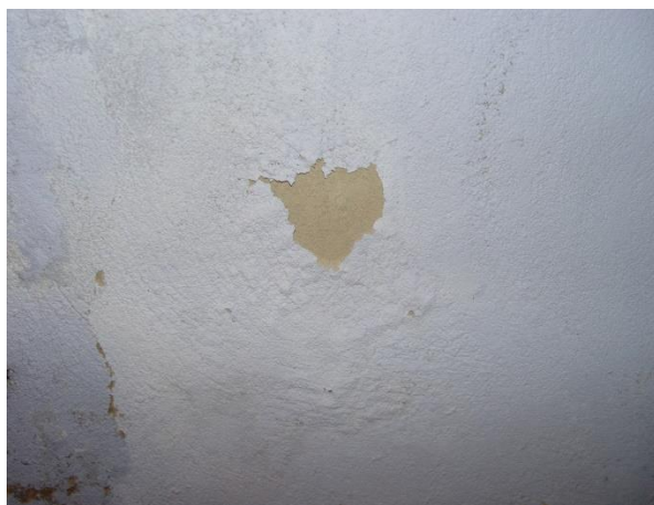
Figura 118 – Pintura descascada no Loteamento Chapéu do Sol
