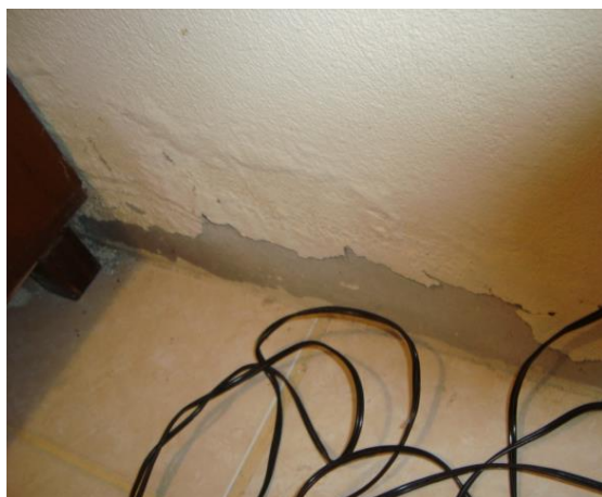
Figura 121 – Pintura descascada no Residencial Nova Chocolateão
