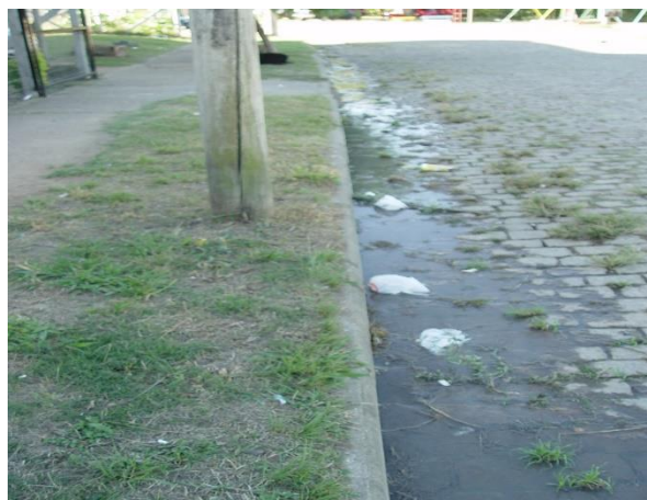
Figura 167 – Problema na rede de drenagem do Loteamento São Guilherme
