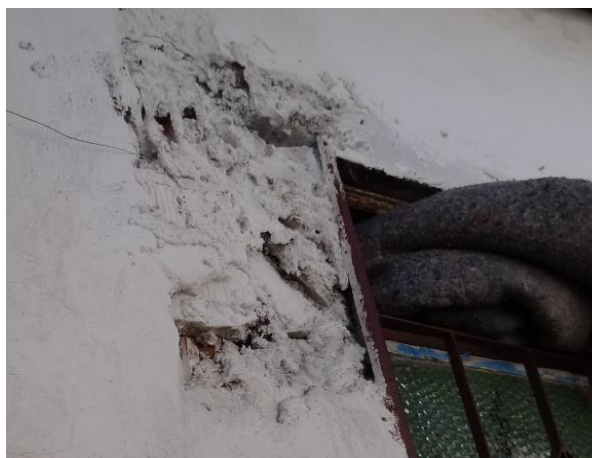
Figura 102 – Revestimento deslocado no Loteamento Chapéu do Sol
