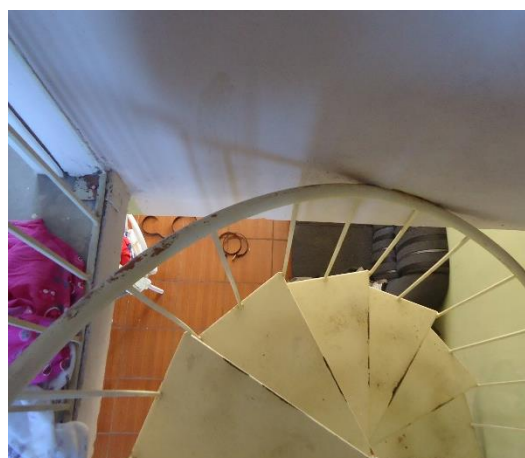
Figura 133 – Pintura desgastada no Residencial Nova Chocolateão
