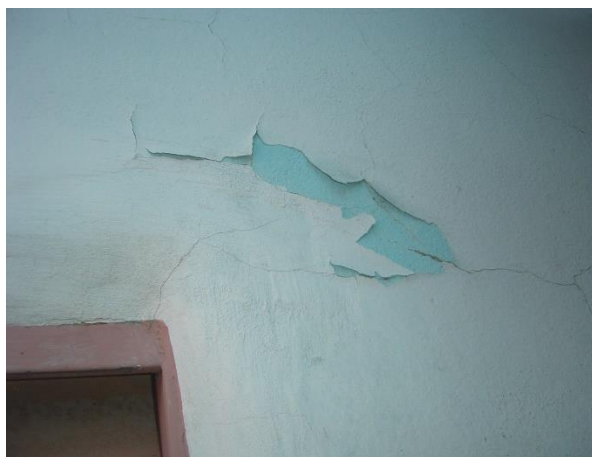
Figura 114 – Pintura descascada no Loteamento Chapéu do Sol
