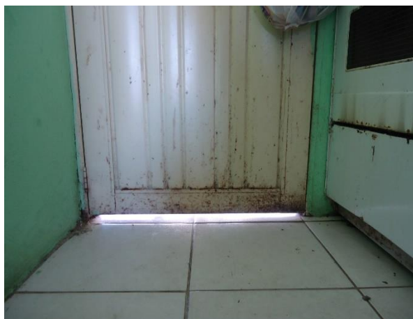
Figura 145 – Porta com incidência de corrosão no Loteamento São Guilherme
