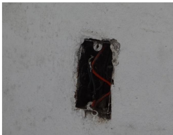
Figura 172 – Fiação Exposta no Loteamento Chapéu do Sol
