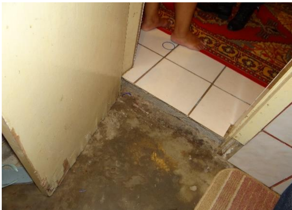
Figura 137 - Porta com a pintura danificada, folha lascada e marco quebrado no Loteamento Chapéu do Sol
