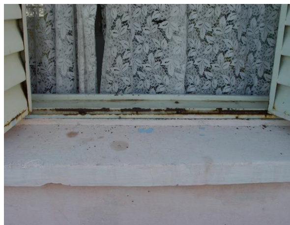
Figura 144 – Janela com incidência de corrosão no Loteamento São Guilherme
