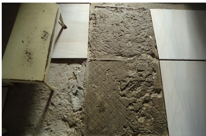
Figura 71 – Piso solto no Residencial Nova Chocolateão
