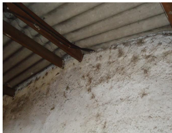
Figura 131 – Pintura manchada no Loteamento Chapéu do Sol
