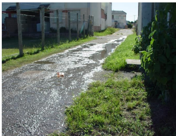
Figura 166 – Problema na rede de drenagem do Loteamento São Guilherme
