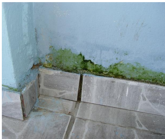
Figura 68 - Umidade proveniente das fundações no Loteamento Chapéu do Sol
