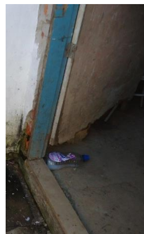
Figura 136 – Porta com pintura danificada e folha lascada no Loteamento Chapéu do Sol
