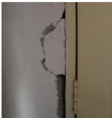
Figura 107 – Revestimento esfarelando e deslocando no entorno da porta no Residencial Nova Chocolateão
