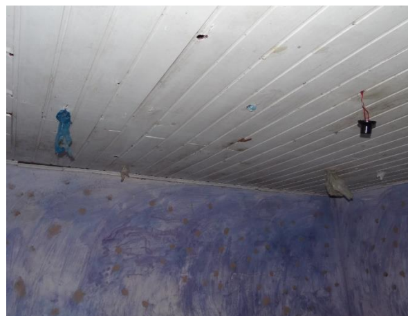
Figura 158 – Forro de madeira deformado no Residencial Nova Chocolateã
