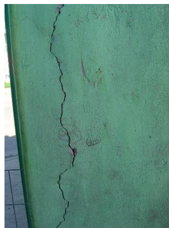
Figura 92 – Parede com fissuras no Loteamento Chapéu do Sol
