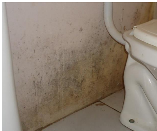
Figura 81 – Parede com mancha de bolor no Residencial Nova Chocolateão
