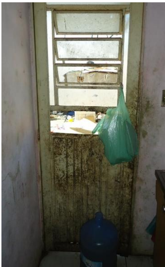
Figura 142 – Porta degradada, com pintura danificada, pontos de corrosão e vidros quebrados
