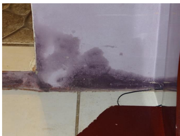
Figura 67 - Umidade proveniente das fundações no Loteamento. Chapéu do Sol
