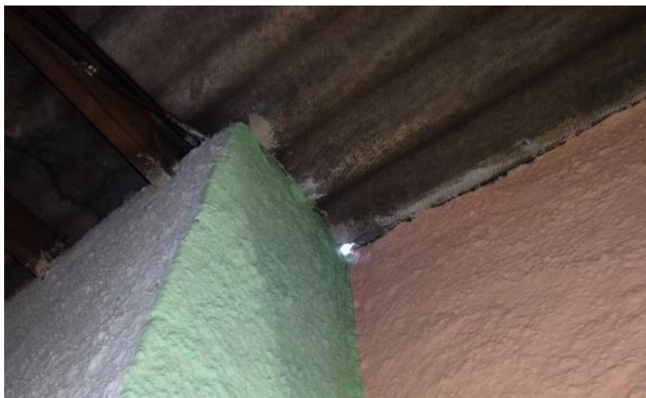
Figura 154 – Cobertura sem forro e com buraco no telhado no Loteamento Chapéu do Sol
