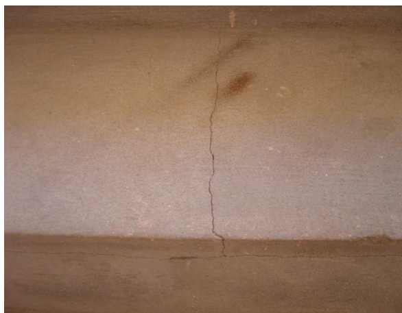
Figura 105 - Revestimento solto no Loteamento São Guilherme
