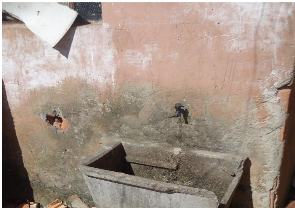
Figura 98 – Revestimento degradado, esfarelado, com manchas de bolor no Loteamento Chapéu do Sol
