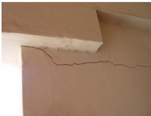
Figura 85 – Parede com fissuras no Loteamento São Guilherme
