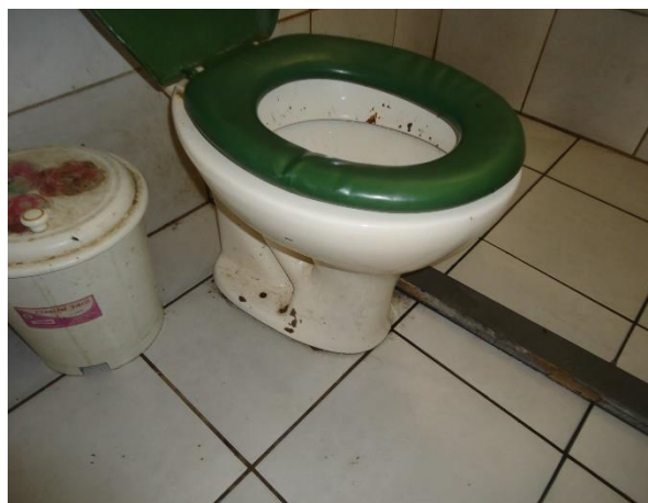
Figura 165 – Falta de vedação no vaso sanitário no Residencial Nova Chocolateão
