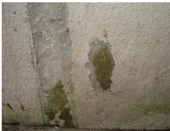
Figura 112 – Pintura descascada no Residencial Nova Chocolateão
