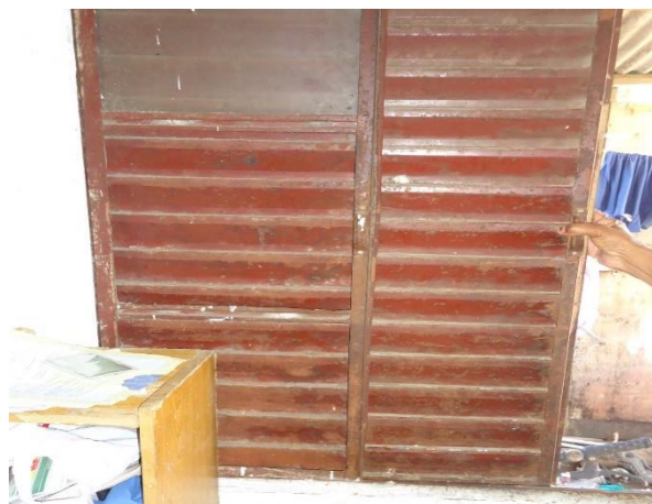
Figura 146 – Janela com incidência de corrosão no Loteamento Chapéu do Sol
