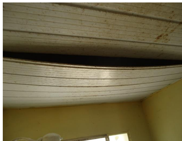
Figura 156 – Forro de PVC deformado no Residencial Nova Chocolateã
