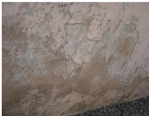
Figura 84 – Parede com fissuras e manchas de bolor no Loteamento Chapéu do Sol
