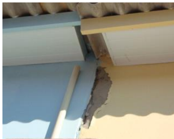
Figura 103 - Revestimento deslocado no Loteamento São Guilherme
