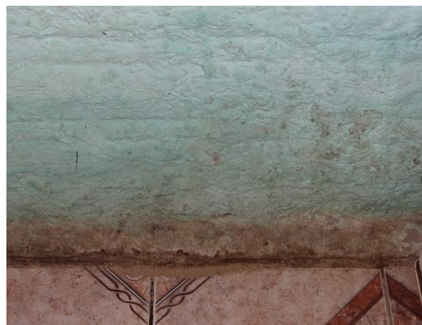
Figura 127 – Pintura manchada no Loteamento Chapéu do Sol
