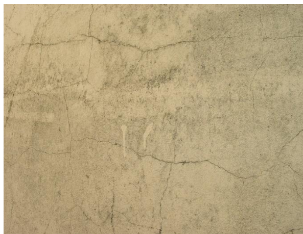
Figura 83 – Parede com fissuras e manchas de bolor no Loteamento Chapéu do Sol
