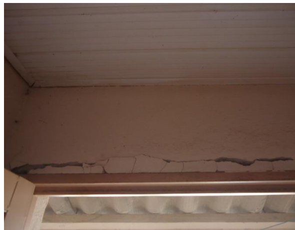
Figura 108 - Revestimento esfarelando e deslocando no entorno da porta no Residencial Nova Chocolateão
