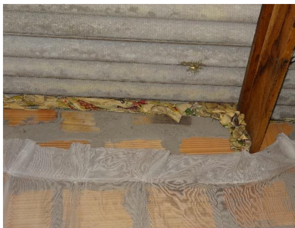
Figura 152 – Unidade sem forro e com jornal para vedação da cobertura no Loteamento Chapéu do Sol
