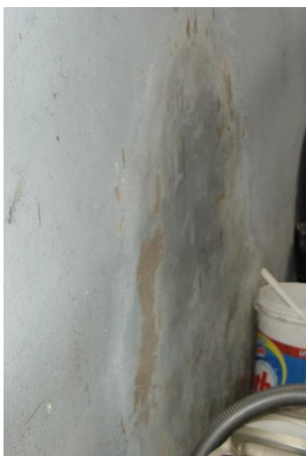
Figura 97 – Revestimento estufado no Loteamento Chapéu do Sol
