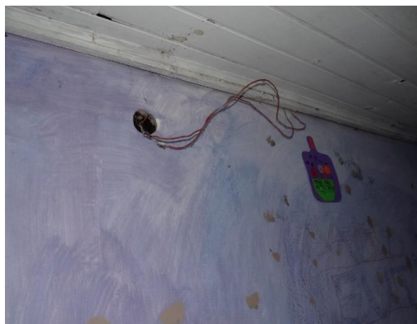
Figura 170 – Fiação Exposta no Loteamento Chapéu do Sol
