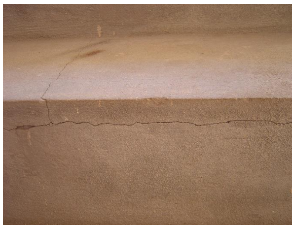
Figura 104 – Revestimento solto no Loteamento São Guilherme
