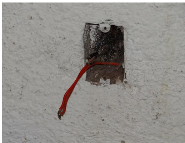
Figura 169 – Fiação Exposta no Loteamento Chapéu do Sol
