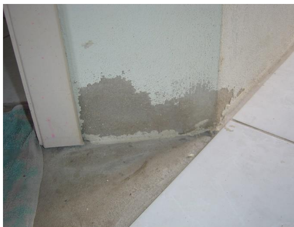
Figura 124 – Pintura descascada no Loteamento São Guilherme
