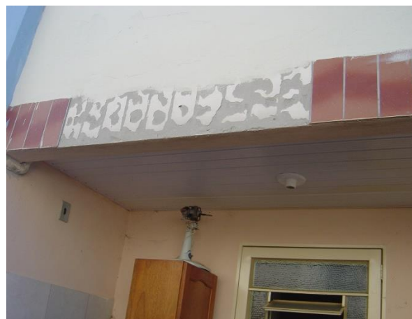
Figura 100 - Revestimento deslocado no Loteamento São Guilherme
