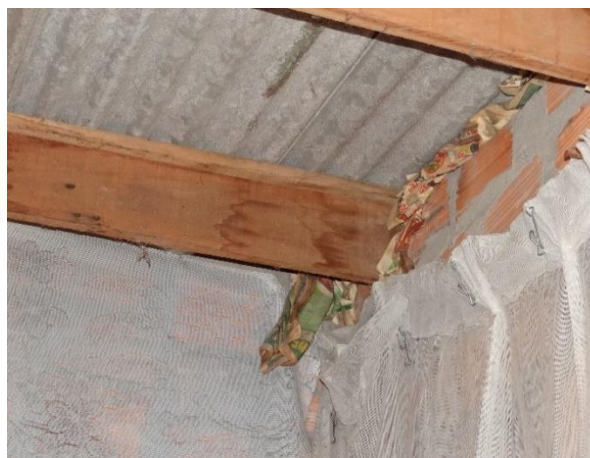
Figura 153 – Unidade sem forro e com jornal para vedação da cobertura no Loteamento Chapéu do Sol
