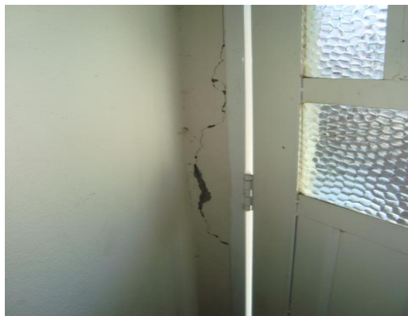
Figura 94 - Parede com fissuras próximo ao batente da porta no Residencial Nova Chocolateão
