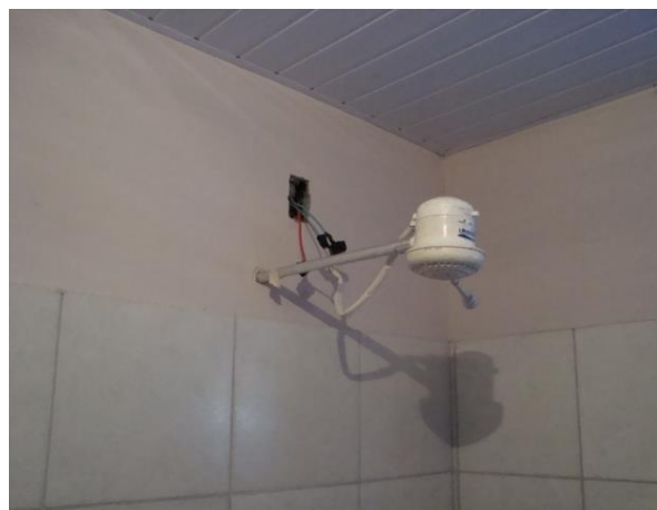
Figura 174 – Fiação Exposta na instalação do chuveiro no Residencial Nova Chocolateão
