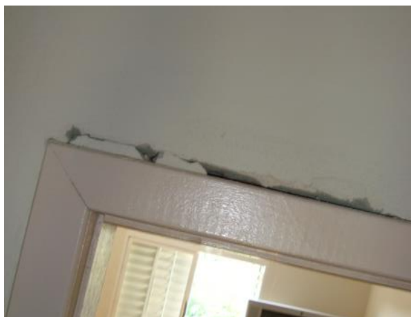
Figura 109 – Revestimento esfarelando no entorno do marco da porta no Residencial Nova Chocolateão
