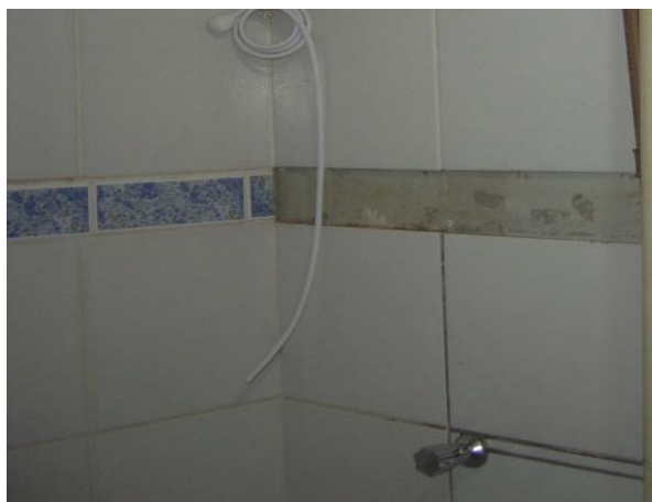
Figura 99 – Revestimento deslocado no Loteamento Chapéu do Sol
