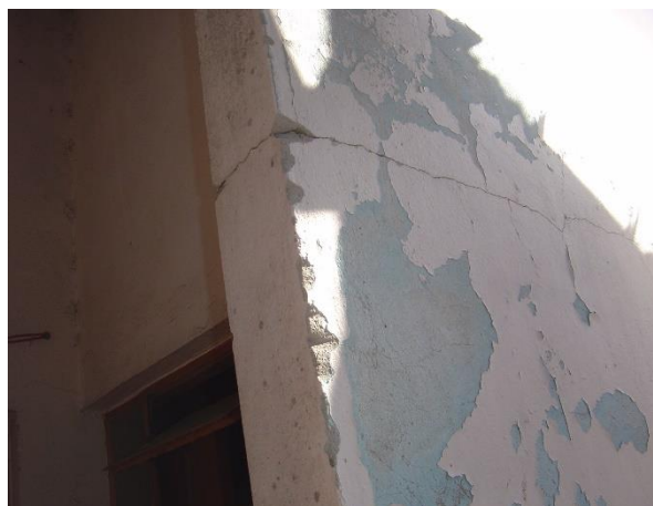
Figura 115 – Pintura descascada no Loteamento Chapéu do Sol
