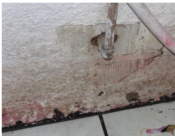
Figura 160 – Vazamento na conexão da tubulação no Loteamento Chapéu do Sol
