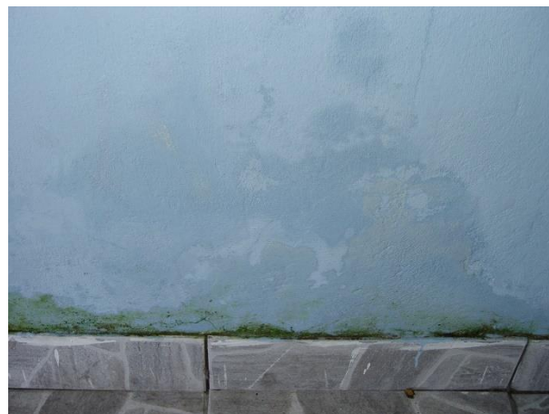
Figura 69 - Umidade proveniente das fundações no Loteamento. Chapéu do Sol
