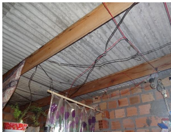
Figura 178 – Instalação elétrica da unidade totalmente exposta no Loteamento Chapéu do Sol
