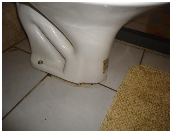
Figura 164 – Falta de vedação no vaso sanitário no Residencial Nova Chocolateão
