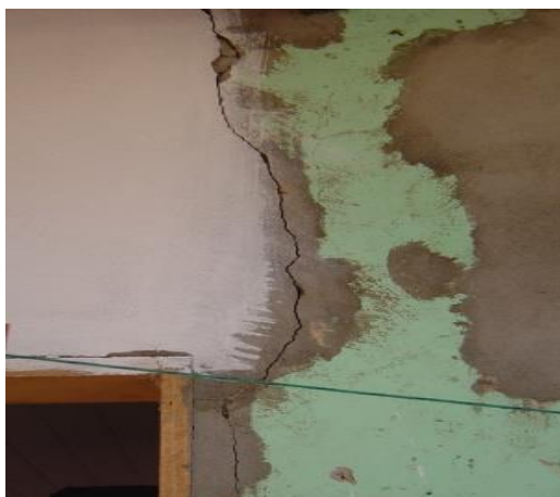
Figura 91 – Parede com fissuras no Loteamento Chapéu do Sol
