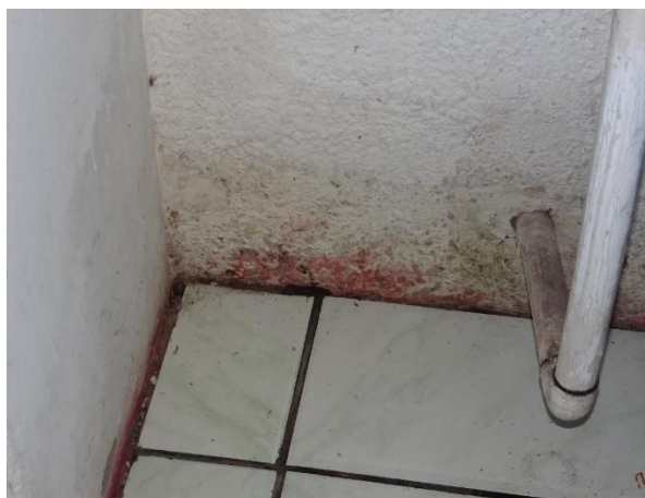
Figura 130 – Pintura manchada no Loteamento Chapéu do Sol
