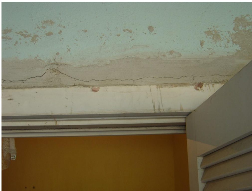
Figura 95 – Parede com fissuras no entorno da janela no Loteamento Chapéu do Sol
