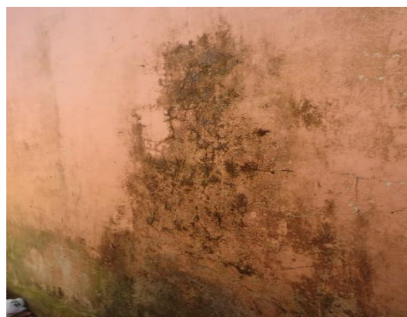
Figura 80 – Parede com manchas de bolor no Loteamento Chapéu do Sol
