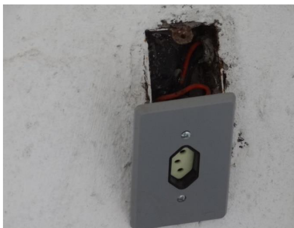
Figura 175 – Acabamento de tomada caído, sendo suportado apenas pela fiação no Loteamento Chapéu do Sol
