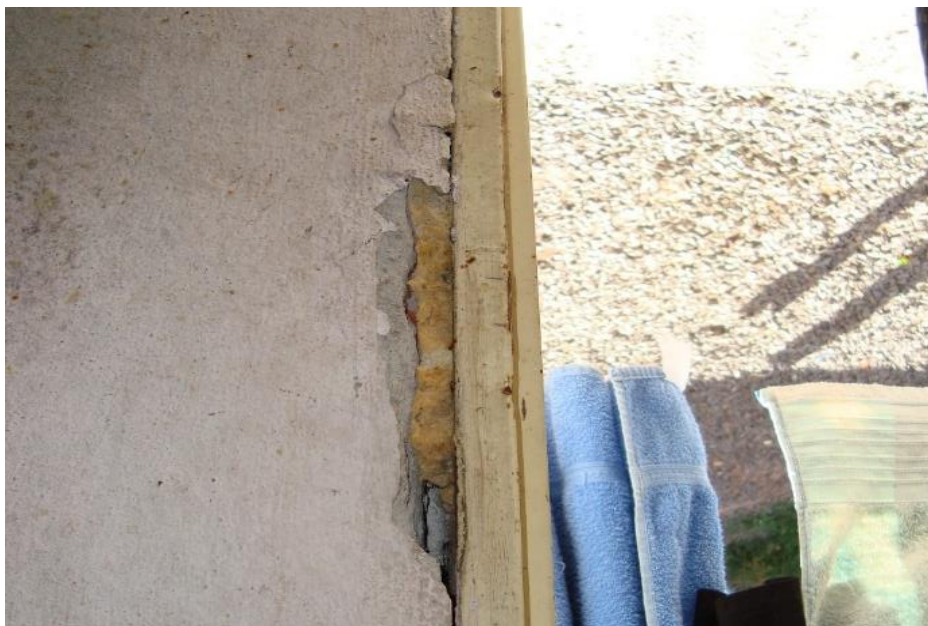
Figura 106 – Revestimento esfarelado e deslocado no ponto de fixação da porta no Loteamento Chapéu do Sol
