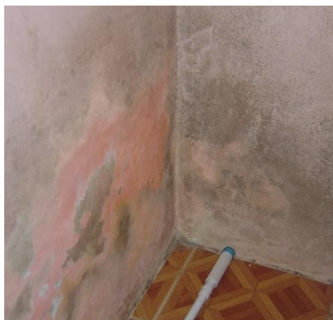
Figura 82 – Parede com manchas de bolor no Loteamento Chapéu do Sol
