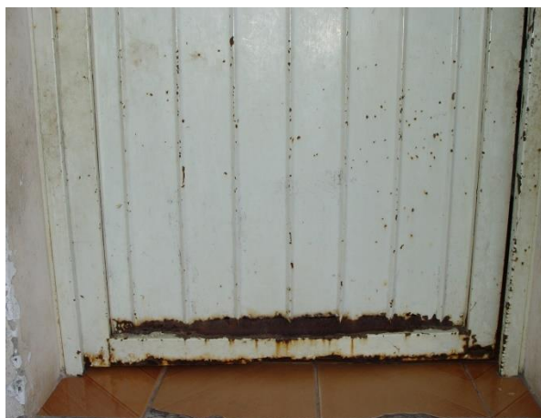
Figura 143 – Porta com incidência de corrosão no Loteamento São Guilherme
