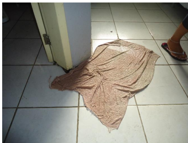
Figura 77 -Alagamento devido ao caimento ao contrário do piso no Residencial Nova Chocolateão
