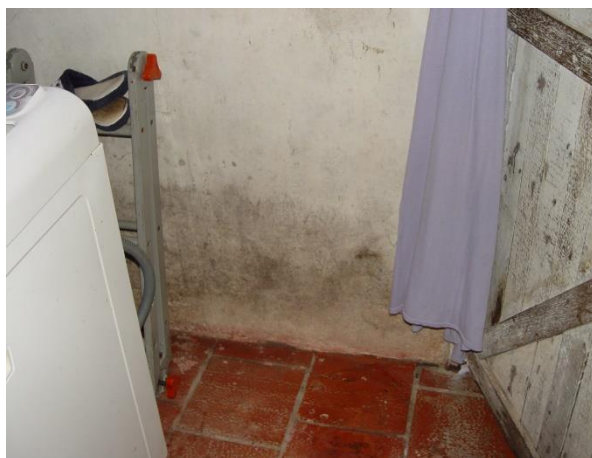
Figura 128 – Pintura manchada no Loteamento Chapéu do Sol
