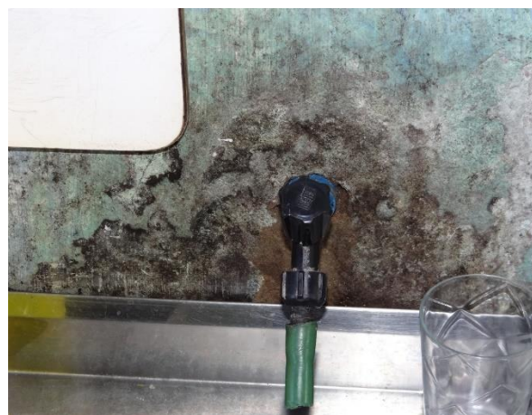
Figura 161 – Vazamento na ligação da torneira no Residencial Nova Chocolate
