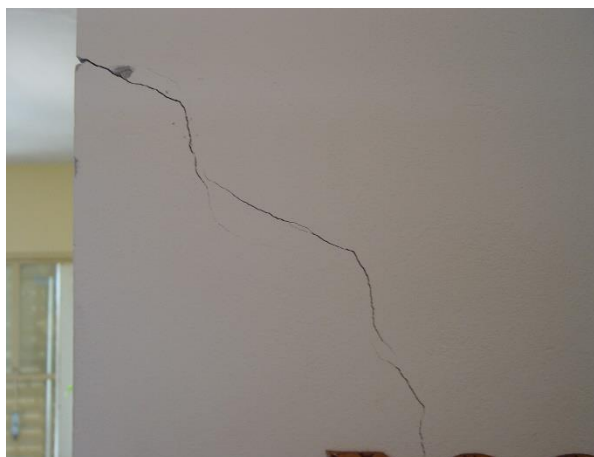
Figura 87 – Parede com fissuras no Loteamento São Guilherme
