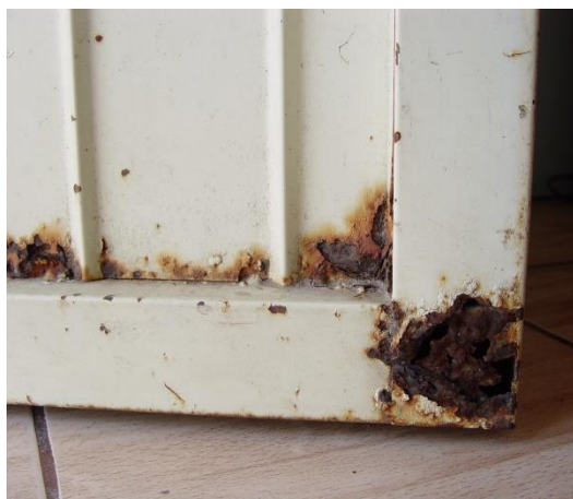
Figura 147 – Porta com incidência de corrosão no Loteamento São Guilherme
