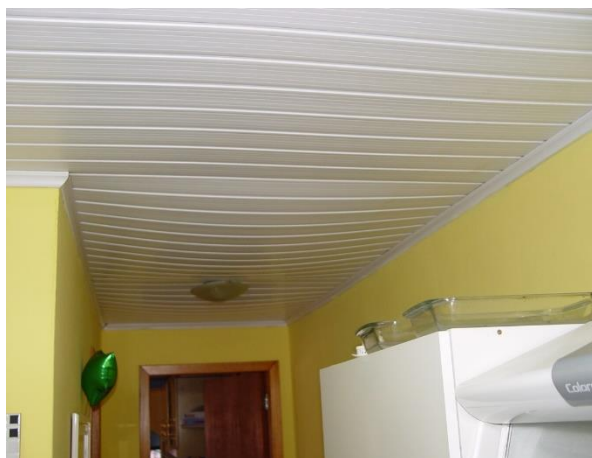
Figura 155 – Forro de PVC deformado no Loteamento Chapéu do Sol
