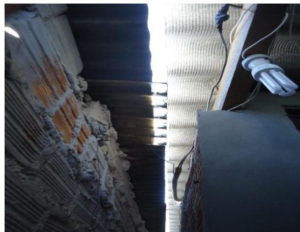
Figura 180 – Instalação elétrica da unidade totalmente exposta no Loteamento Chapéu do Sol
