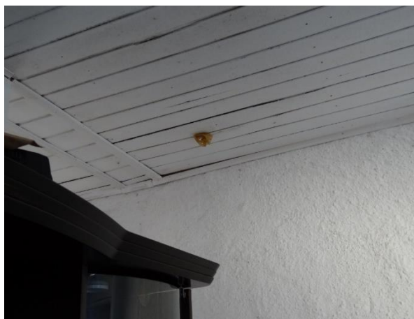
Figura 157 – Forro de madeira deformado no Loteamento Chapéu do Sol
