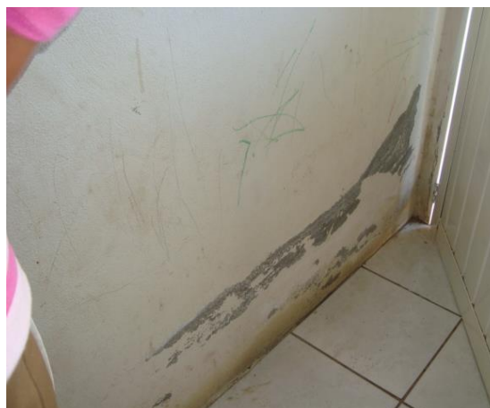
Figura 123 – Pintura descascada no Residencial Nova Chocolateão
