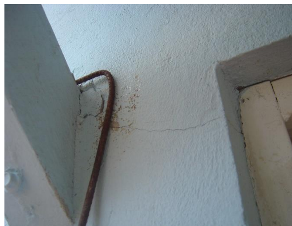
Figura 90 – Parede com fissuras no Loteamento São Guilherme
