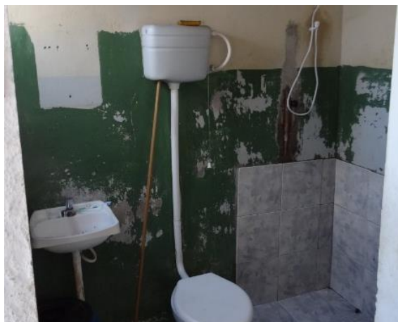
Figura 122 – Pintura descascada no Loteamento Chapéu do Sol
