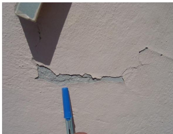
Figura 113 – Pintura descascada no Loteamento São Guilherme
