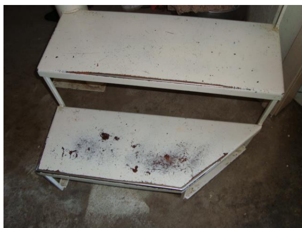
Figura 132 – Pintura desgastada no Residencial Nova Chocolateão
