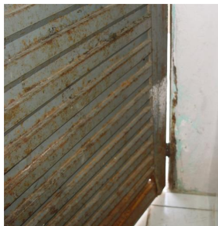
Figura 148 – Porta com incidência de corrosão no Loteamento São Guilherme
