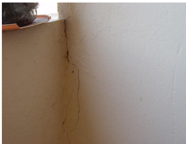
Figura 89 – Parede com fissuras no Loteamento São Guilherme
