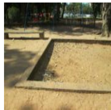
(c) Falta de reposição de areia caixa do escorregador
