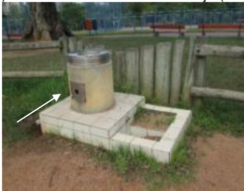
(e) Falta de acionador no bebedouro
