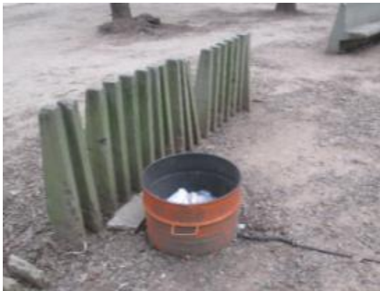
(a) Falta de conservação da cerca
