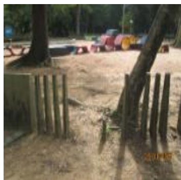
(b) Cerca com partes faltando
