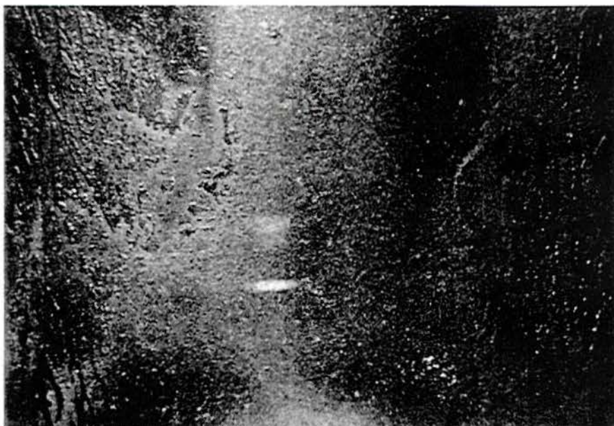
Figura 4.2.15. 03MB03B - Pista externa LA detalhe – esfoliação da pista.
