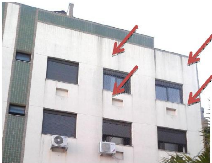
Figura 12 – Manchamento de fachada abaixo do peitoril pela sujidade transportada pela água da chuva
