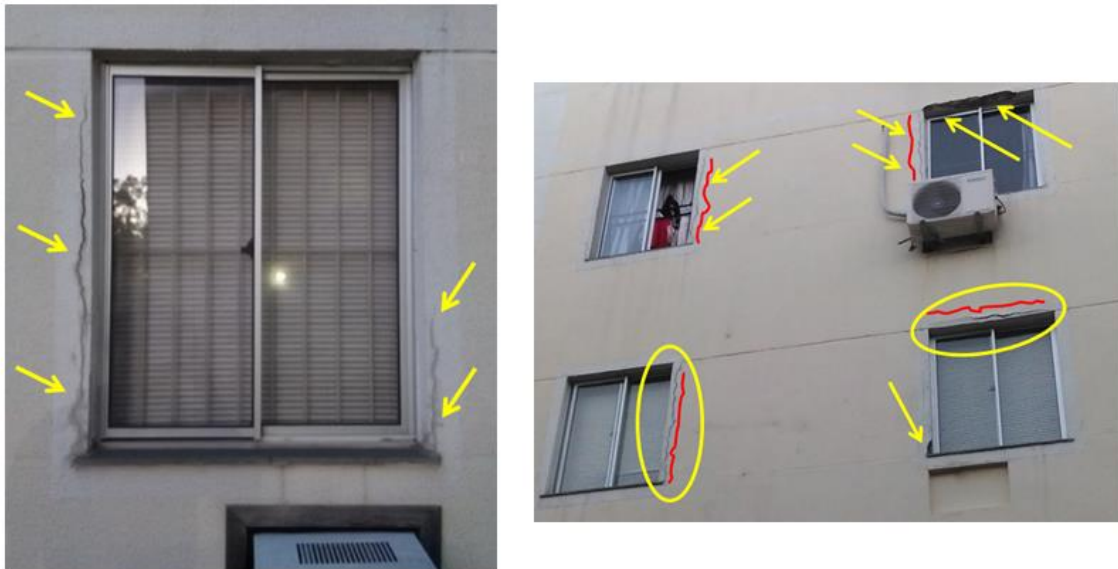
Figura 40 – Fissuras no entorno das esquadrias – Construtora “O”
