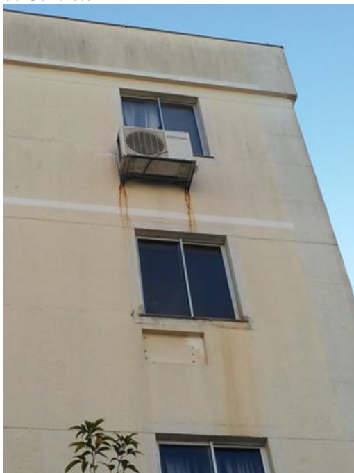
Figura 45 – Sujidade em: topo, abaixo das janelas e pela improvisação de instalações de equipamentos – Bloco de Concreto
