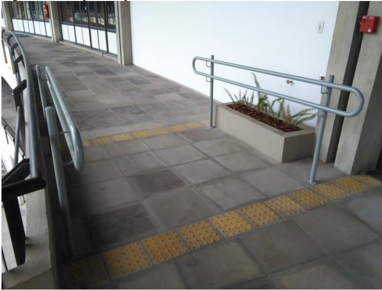
Figura 4 – Rampa com piso tátil de alerta e corrimão em ambos os lados e com duas alturas do piso
