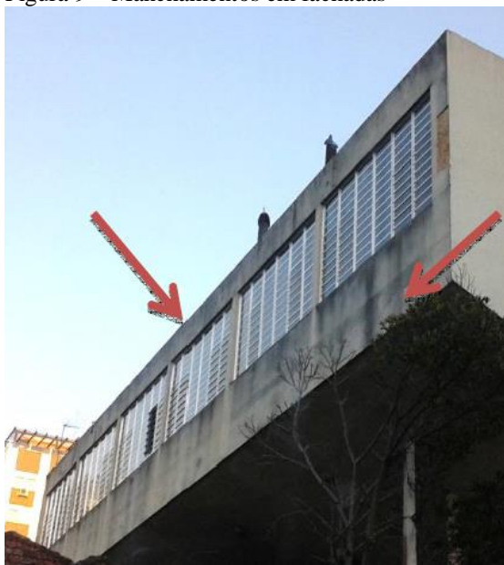
Figura 9 – Manchamentos em fachadas
