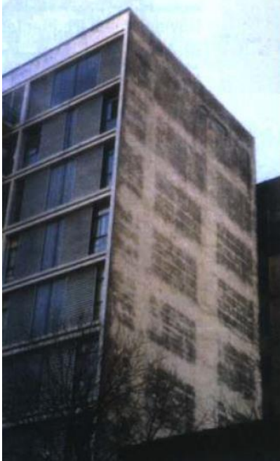
Figura 10 - Incidência de espectro de juntas ou “fantasmas” em fachada de uma edificação
