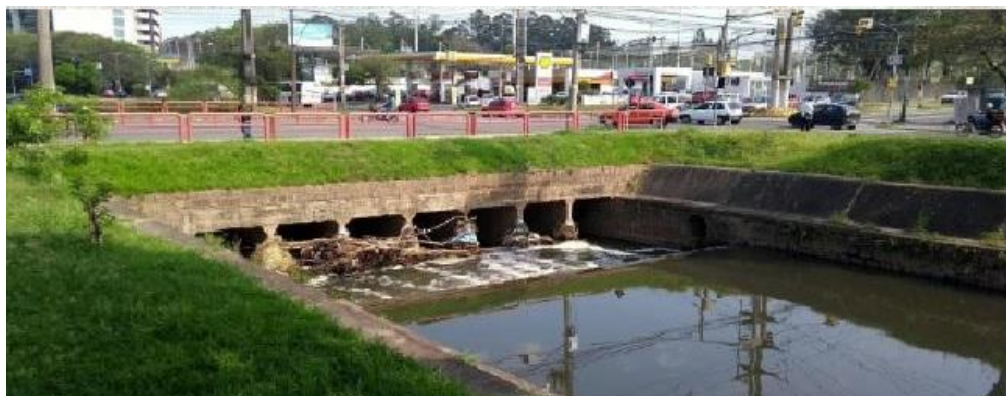
Figura 0.4: A - Seção transversal projetada para a canalização e construção da Av. Ipiranga. Fonte: SILVA (1943). B - Ponte do cruzamento entre as avenidas Ipiranga e Prof. Cristiano Fischer. Lixo acumulado nos pilares da ponte (fev. 2018).
