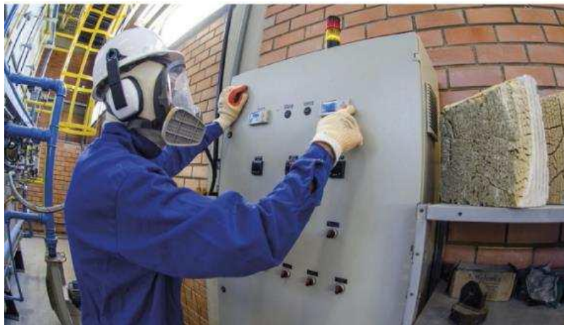
Figura 14 - Painel de operação do forno vertical empregado
