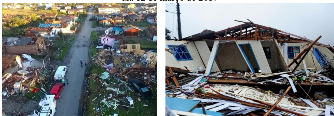
Figura 2 – Fotos da destruição provocada pelo tornado que atingiu São Francisco de Paula no dia 12 de março de 2017
