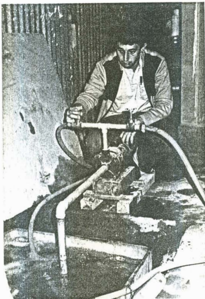
Foto 13 - Ajuste grosseiro da vazão de água.
