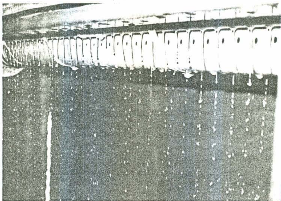
Foto 02 - Detalhe da barra de aspersão (sem aplicação de ar).
