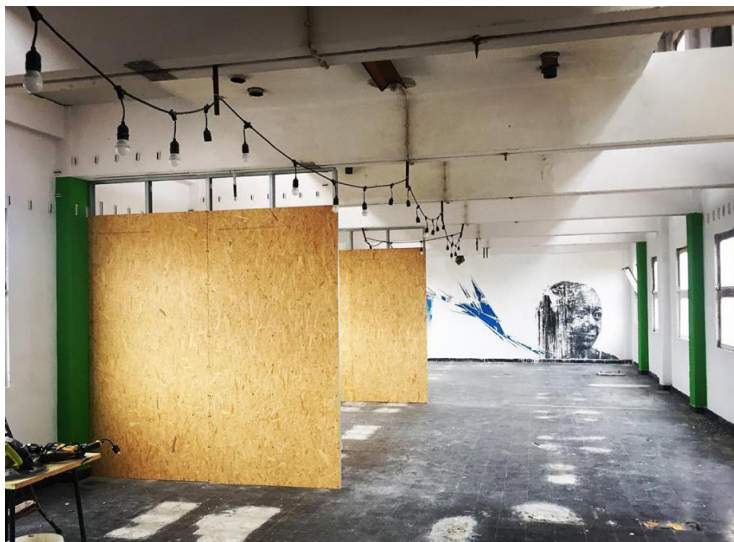
Figura 119 Silos Contentor Criativo - espaços para aluguel que sofreram apenas limpezas, pequenos consertos e instalações de infraestrutura básica.
