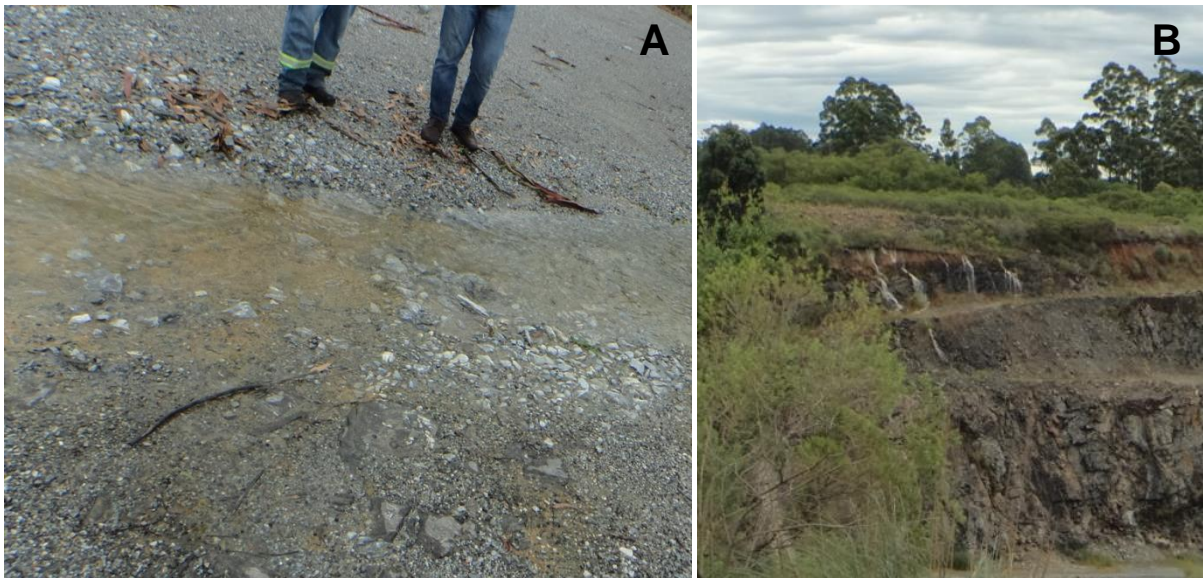
Figura 3 - Processos que devem sofrer intervenção no empreendimento: (a) vertente de água sobre o piso da praça de estoque e (b) extravasamento de água em talude sul da cava de extração.
