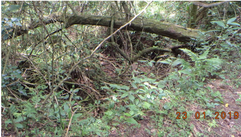
Figura 9 - Erosão do solo no ponto de descarga da água sifonada, a sul da cava de extração.
