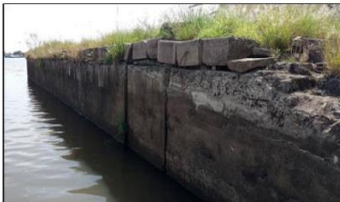
Figura 41 - Lâmina d'água no Cais Mauá na campanha de 09/03/2018
