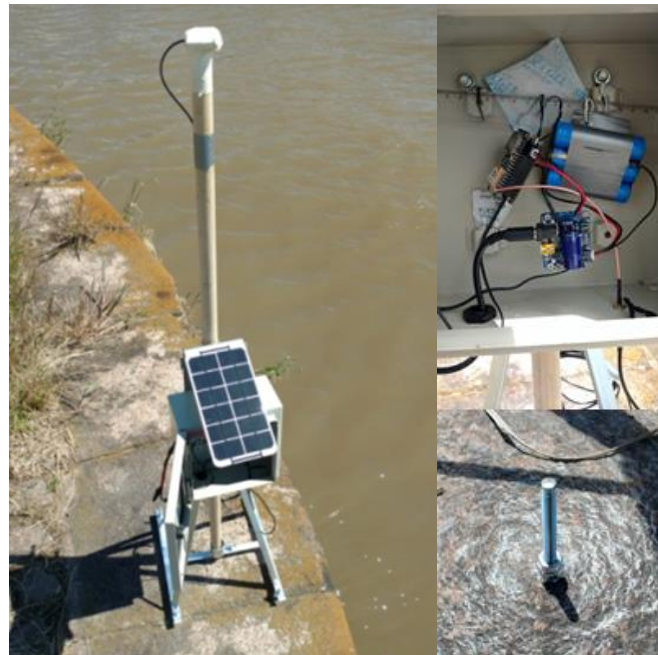
Figura 27- Instalação no Cais Mauá: Instalação da estação permanente (esquerda), interior (direita-acima) e parafusos de fixação (direita-abaixo)
