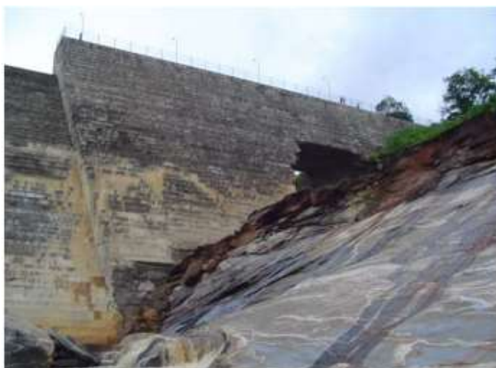
Figura 9. Brecha da Barragem de Camará (Fonte: BARBOSA et al., 2004).
