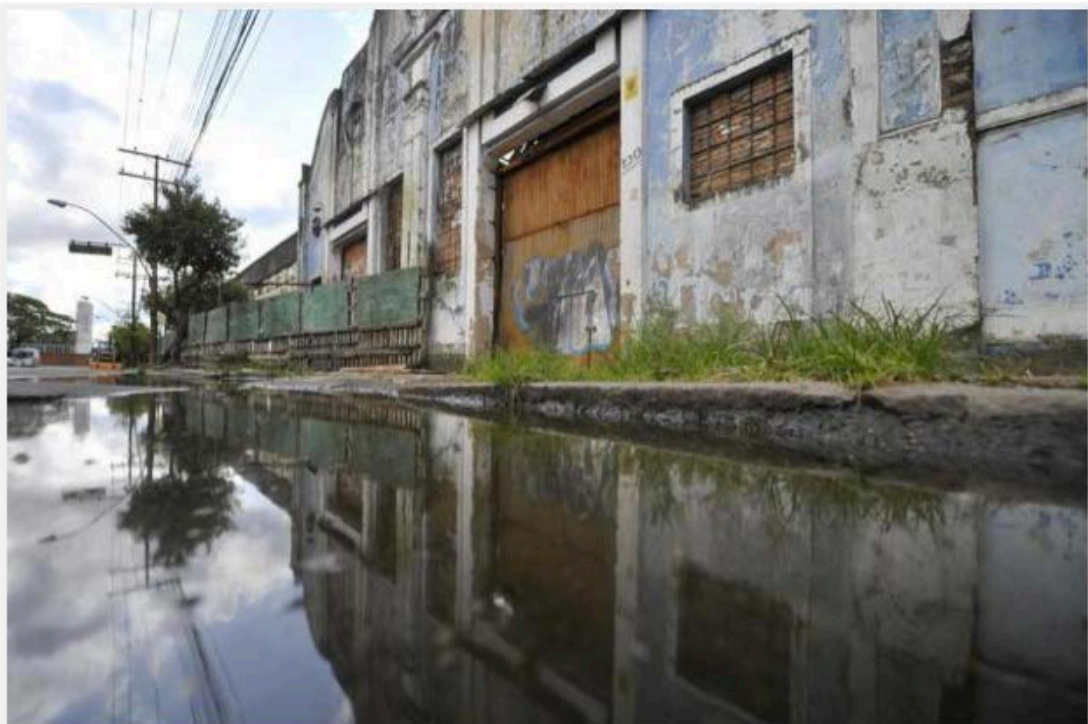
Antiga fábrica de fogões da Wallig, projeto de Theo Wiederspahn, de 1921, é um retrato de como ficaram os armazéns industriais. Fotos: Lauro Alves / Agencia RBS
