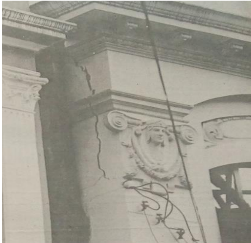
Figura 16 - Rachadura na fachada do prédio após incêndio em 1996
