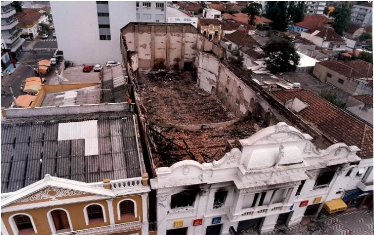
Figura 10 - A parte interna do prédio foi totalmente perdida
