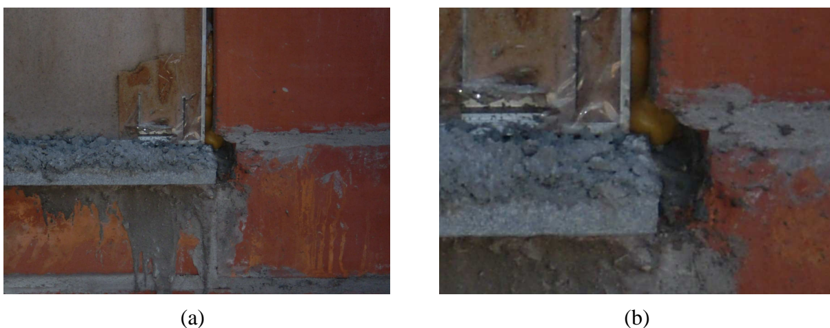
Figura 57: (a) Caso de peitoril com prolongamento longitudinal insuficiente em relação a aresta lateral da janela, estando sujeito à infiltrações na sua extremidade;(b) Ampliação de (a).
