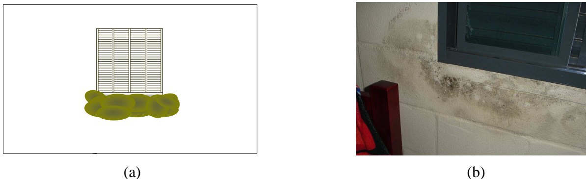
Figura 46: (a) Configuração típica de mancha característica de umidade na região próxima ao peitoril; (b) caso de umidade devido a infiltração na região próximo ao peitoril.
