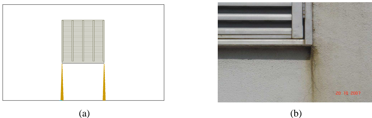
Figura 51: (a) configuração típica encontrada: sujidade do revestimento externo próximo às extremidades do peitoril devido ao seu insuficiente prolongamento longitudinal; (b) sujidade do revestimento na região próxima às extremidades do peitoril devido a prolongamento longitudinal insuficiente deste componente.
