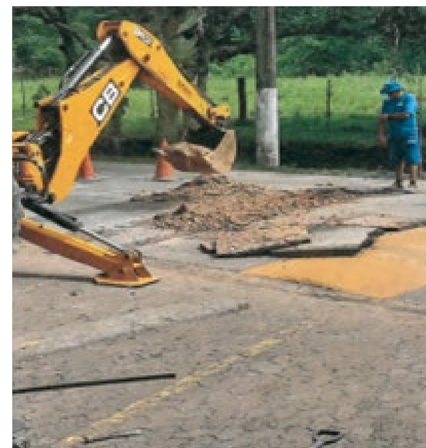
Abertura do asfalto
