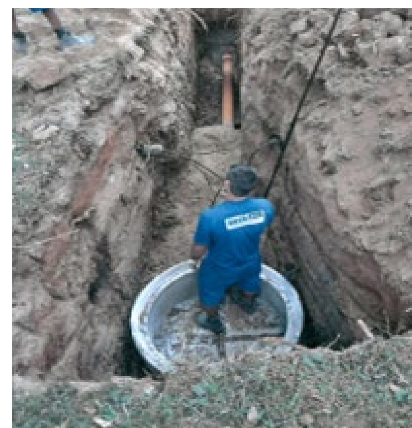
Poço de visita e tubulação
