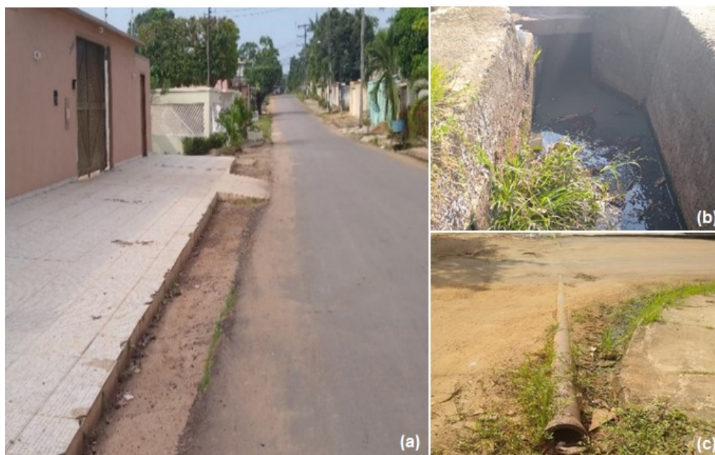
Figura 27 – (a) Rampas impedindo a passagem do fluxo de águas pluviais nas sarjetas, (b) tubulação de ferro fundido adaptado para funcionar como sarjetão e (c) valas de drenagem aberta com dimensão de um metro de largura no município de Itacoatiara-AM
