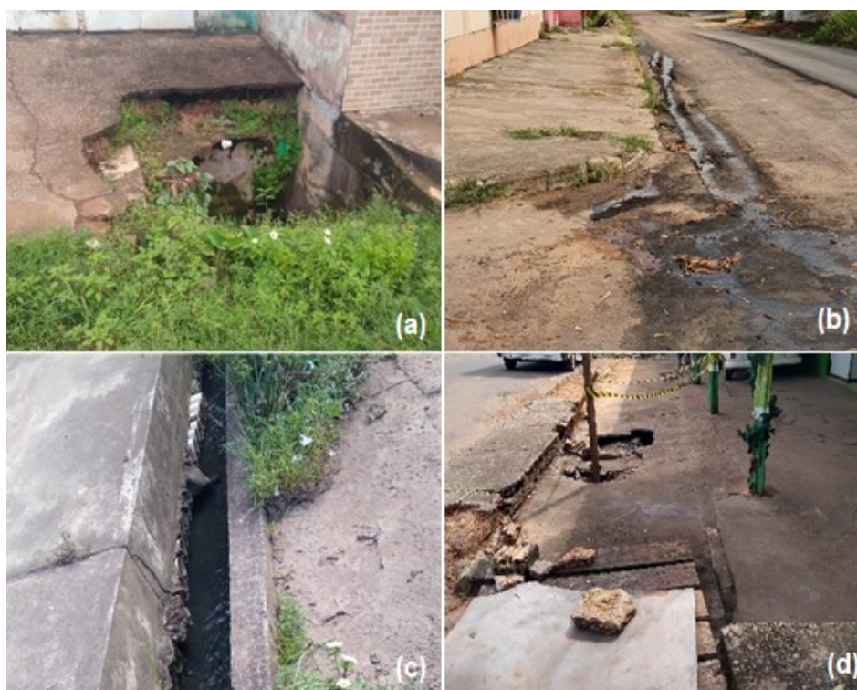
Figura 28 – (a) Poço de visita de drenagem sem tampa, (b) pavimentação sendo realizada com escoamento de água servida na rua, (c) ligações de esgoto na rede de drenagem e (d) galeria de drenagem com problemas estruturais no município de Itacoatiara-AM
