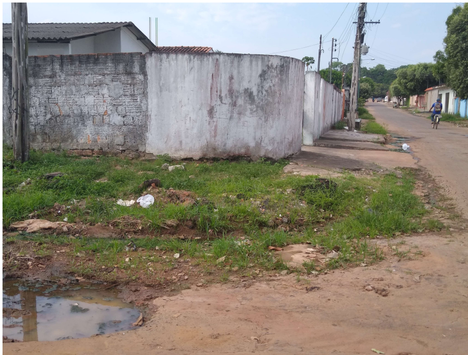
Figura 12 – Erosão da via pública no município de Itacoatiara-AM devido à falta de drenagem
