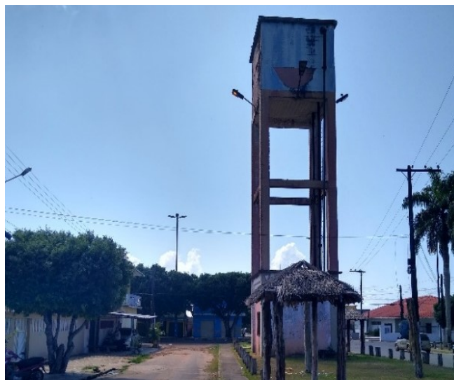
Figura 19 – Reservatório de água desativado devido à falta de manutenção no município de Itacoatiara-AM
