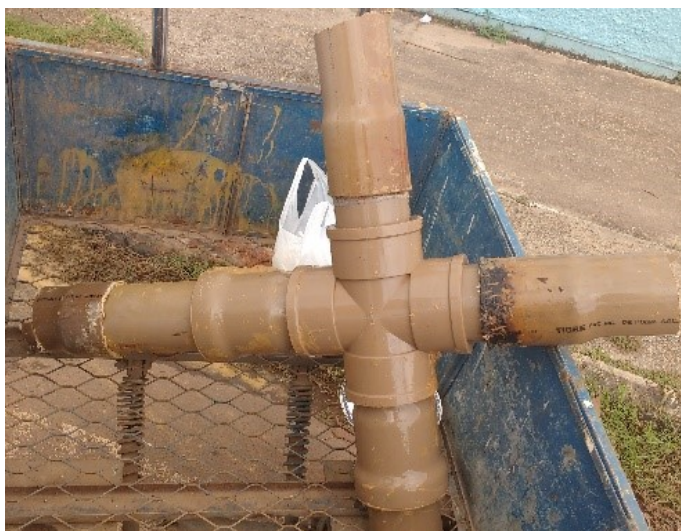
Figura 18 – Adaptações de conexões e tubos na rede de distribuição de água do município de Itacoatiara-AM
