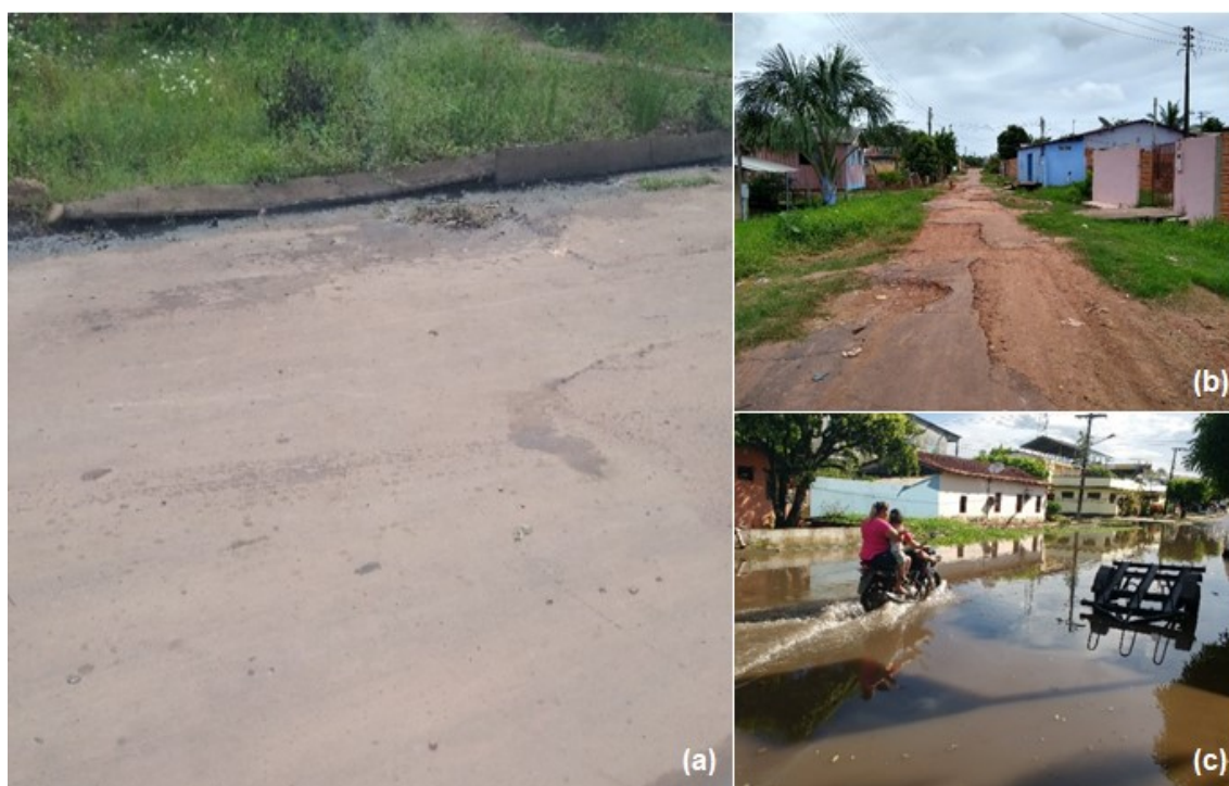
Figura 24 – (a) Pranchas de madeira servindo como meio-fio, (b) pavimentação sem manutenção e sem componentes de drenagem e (c) mal dimensionamento do sistema de drenagem do município de Itacoatiara-AM
