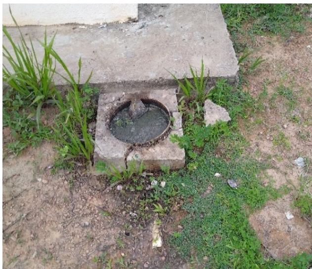
Figura 21 – Caixa de inspeção que interliga na rede predial de esgoto entupida no bairro Jacarezinho do município de Itacoatiara-AM
