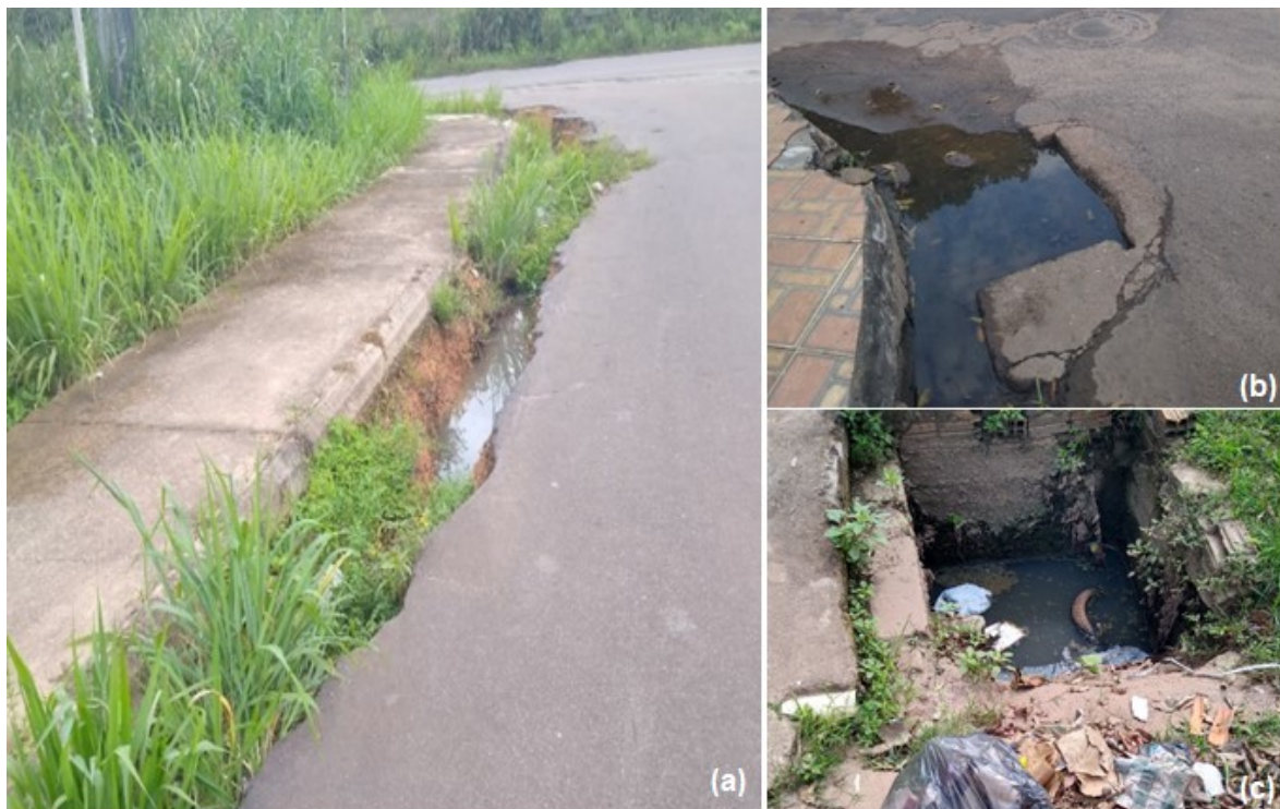
Figura 26 – (a) Falta de manutenção da sarjeta, (b) bocas de lobo e (c) acúmulo de resíduos sólidos nas valas de drenagem do município de Itacoatiara-AM
