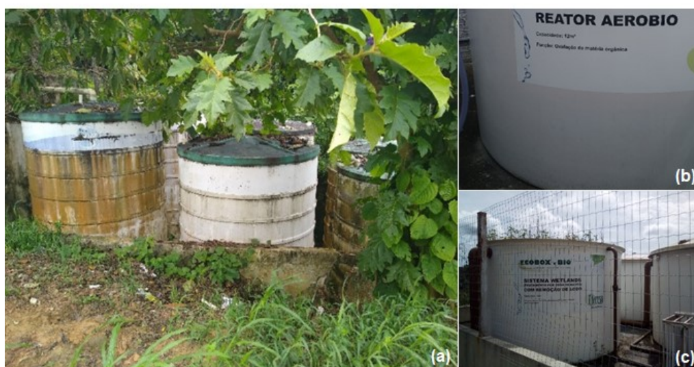
Figura 23 – (a) Muro de contenção dos tanques de tratamento de esgoto com risco de colapsar, (b) reator aeróbio com inserção de ar abaixo do ideal e (c) falta de plantas aquáticas na ETE do município de Itacoatiara-AM
