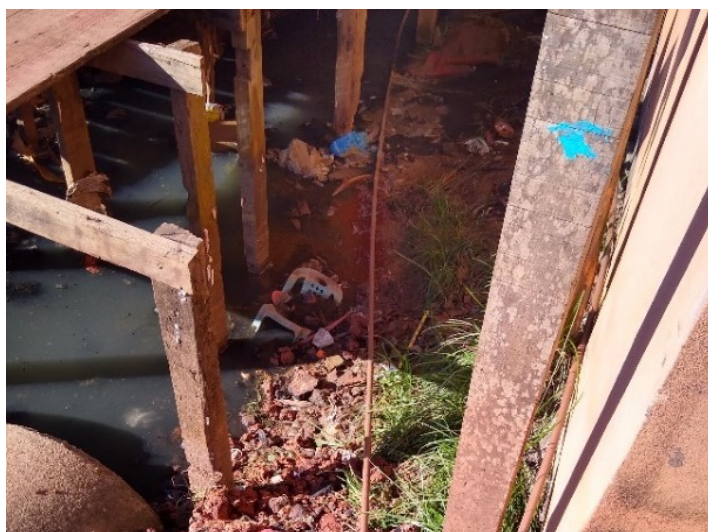
Figura 15 – Ligação predial de água em contato com esgoto e sem ancoragem em alguns domicílios do município de Itacoatiara-AM
