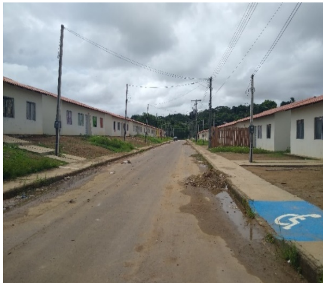
Figura 29 – Acúmulo de águas pluviais nas sarjetas de Itacoatiara-AM
