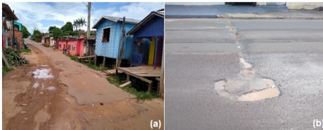
Figura 14 – (a) Falta de recomposição asfáltica (b) recomposição asfáltica realizada com cimento na via pública do município de Itacoatiara-AM
