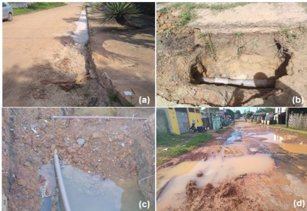
Figura 17 – (a) Areia no recobrimento da tubulação de água, (b) vala aberta por tempo prolongado, (c) compactação sendo realizada com presença de água após a manutenção da rede de distribuição de água e (d) demora para realizar o reoparo na rede de distribuição de água com vazamento no município de Itacoatiara-AM
