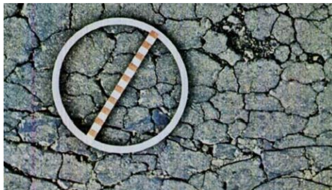
Figura 7 - Trincamento por fadiga do pavimento asfáltico Fonte: DNIT 005/2003-TER.
