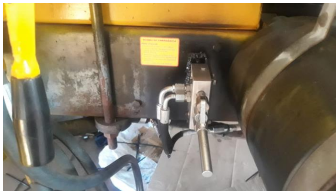
Figura 37 - Bomba de emergência.
