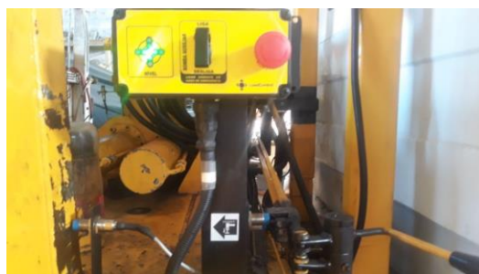
Figura 42 - Caixa de emergência
