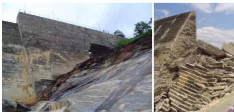
Figura 3 - Barragem de Camará após o acidente. FONTE: Balbi, 2008
