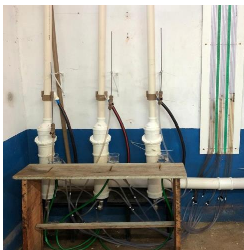
Figura 1: Sistema em pré-operação. Filtro 1, 2 e 3 com alimentação constante e monitoramento de perda de carga através do painel de medições dos piezômetros, além de análise de água filtrada.
