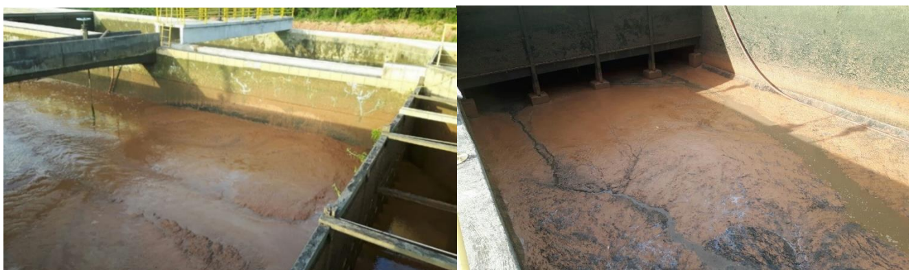
Figura 6: Decantadores da SEMAE em São Leopoldo/RS após os desastres de Rolante/RS (fonte: SEMAE).
