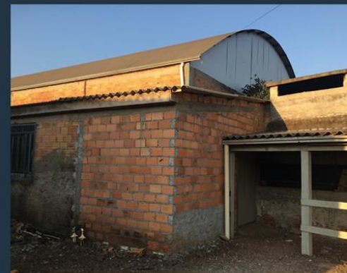
edificações em estado precário
