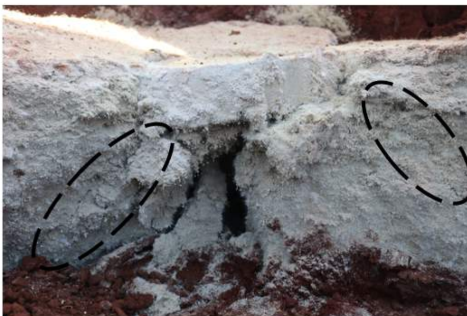
Figura 5.13 – Inclinação das trincas de tração na camada de Dr90 Sem Álcali
