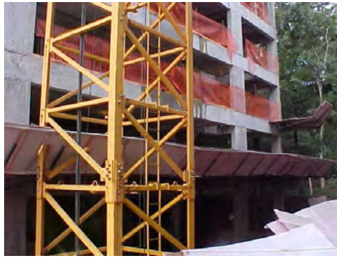
Figura 4-9-3. Interferência entre a grua e a plataforma principal de proteção
