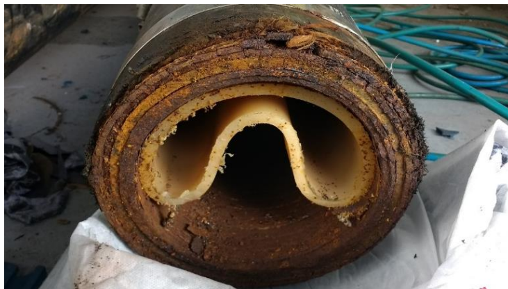
Figura 7 - Duto smooth bore colapsado.
