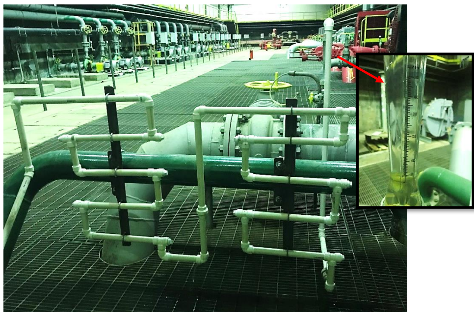
Figura 15 – Coluna de corrosão instalada e detalhe do rotâmetro.
