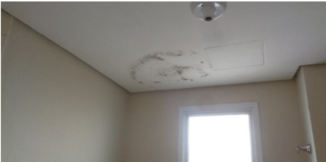
Figura 35 – Exemplo de falha de estanqueidade na tubulação de esgoto (manchamento no forro)
