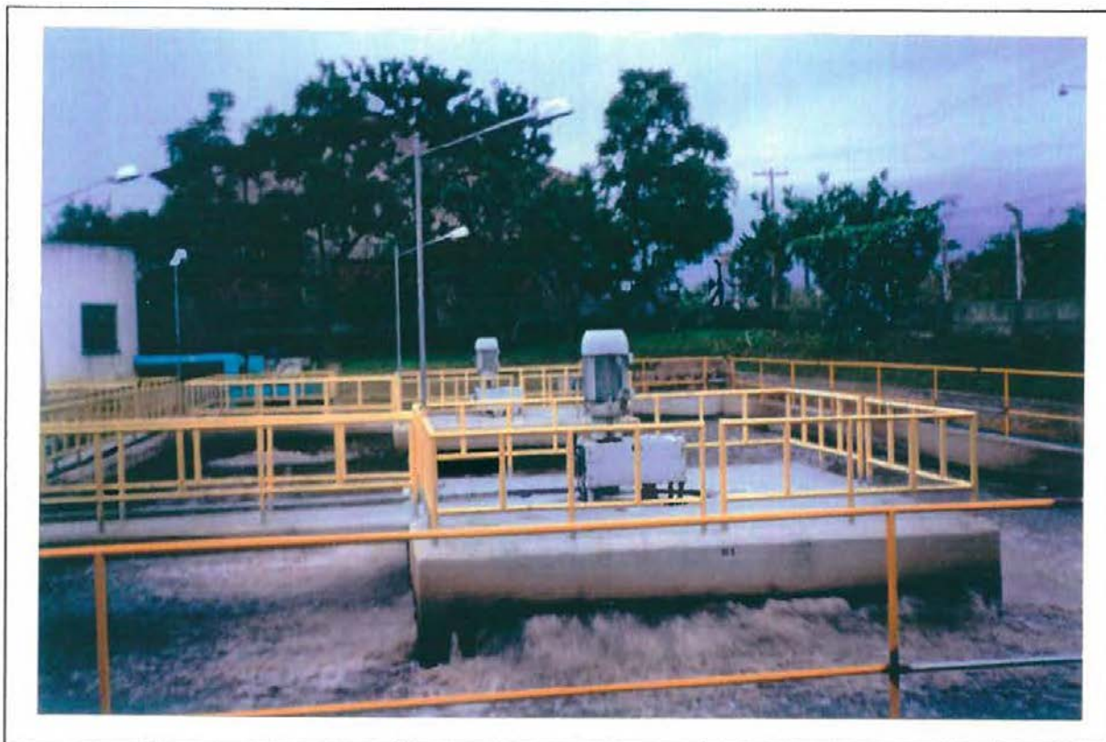
FIGURA 4.3: Estação de tratamento de esgoto Arvoredo - DMAE/POA-RS
