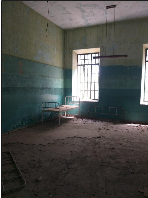
Imagem 18: Quarto em ruínas no prédio antigo/ HPSP
