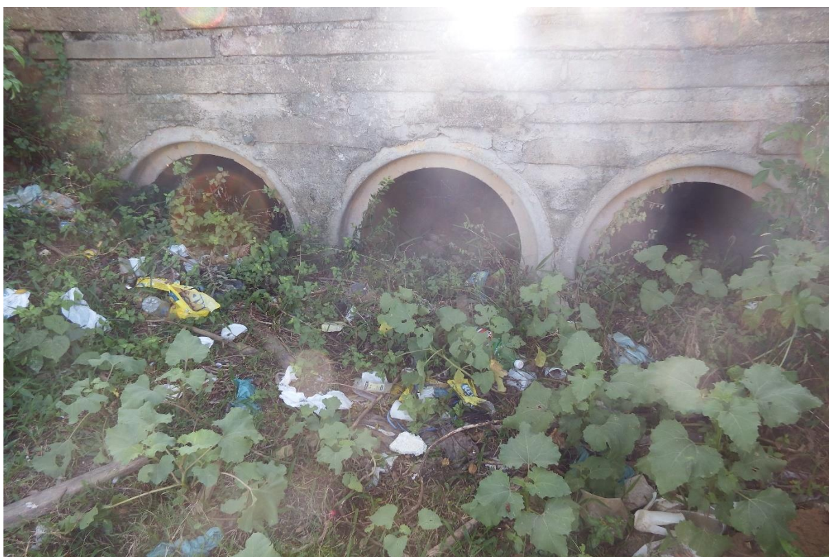
Figura 111. Resíduos sólidos obstruindo a canalização da drenagem na Sub-bacia do Arroio Teixeira. FONTE: Autora, 2021.
