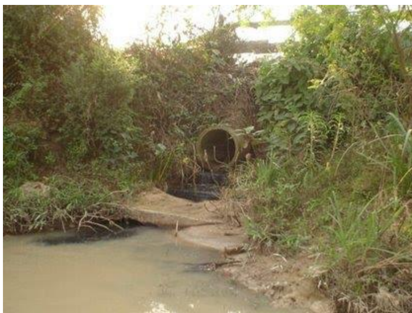
Figura 108. Canalização com lançamento de Esgoto na Sub-bacia Arroio Teixeira. FONTE: OsverdesdeTapes, 2005.
