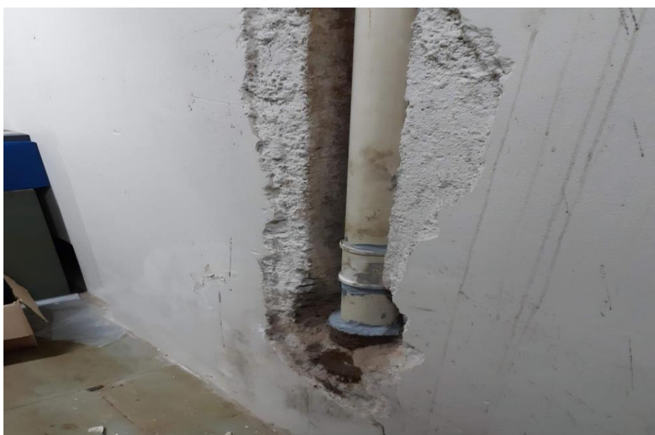
Figura 14 - Encanamento de esgoto - sala do Arquivo
