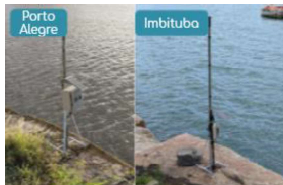
Fig. 6 - Instalações do sensor refletométrico em campo: Porto Alegre (RS) e Imbituba (SC)
