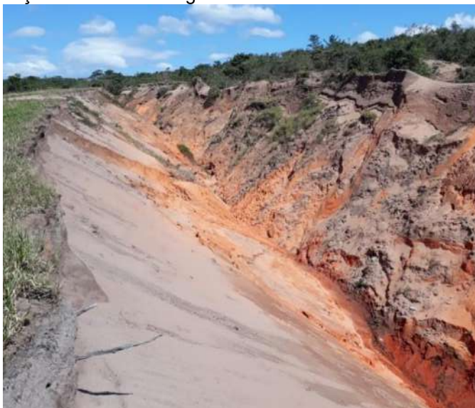
Figura 33 – Feições erosivas e surgimento de areais em Reserva do Cabaçal (MT)
