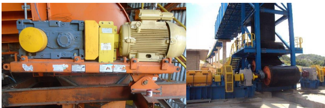
Figura 1 – Unidades de acionamento de uma correia transportadora.
