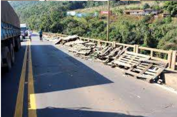
Figura 31: Fotos de acidentes em pontes com largura reduzida (pontes estreitas)
