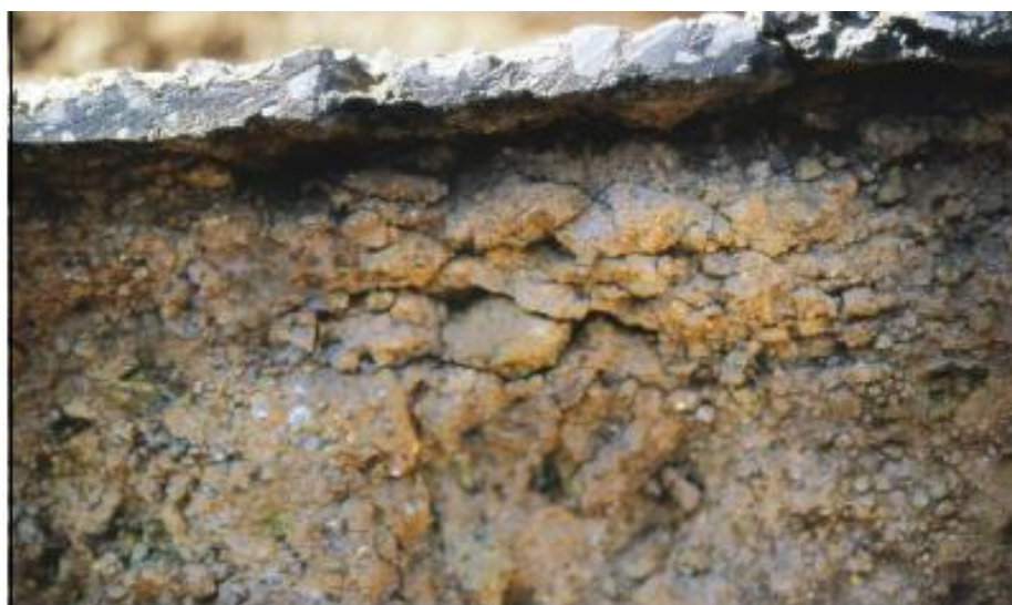
Figura 2.22 – Esmagamento/fragmentação de uma camada base levemente cimentada
