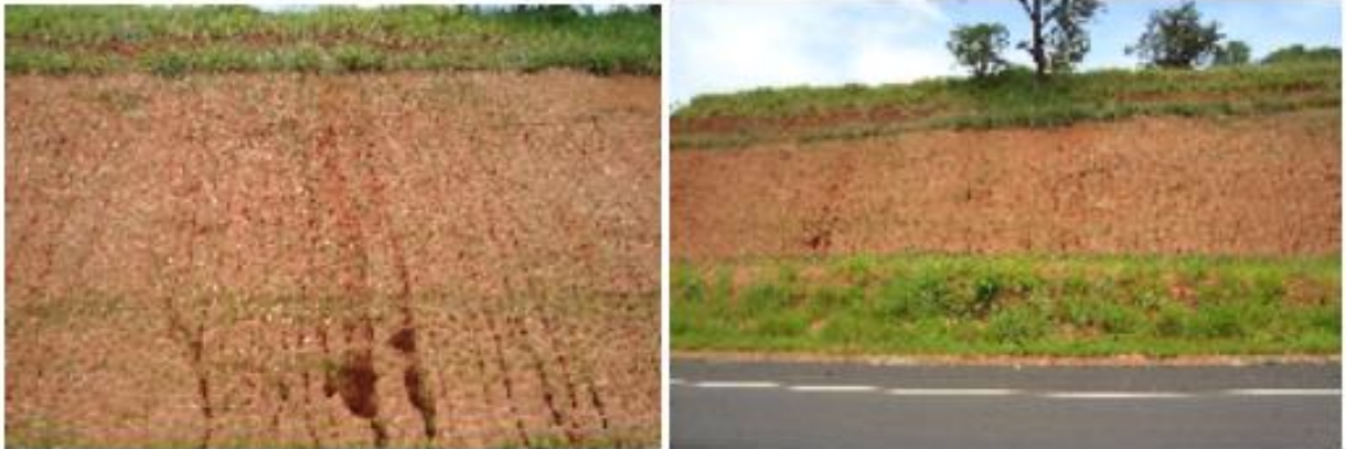
FIGURA 12 - Cobertura de hidrossemeadura de solo arenoso com geração de focos erosivos após o período de chuvas.
