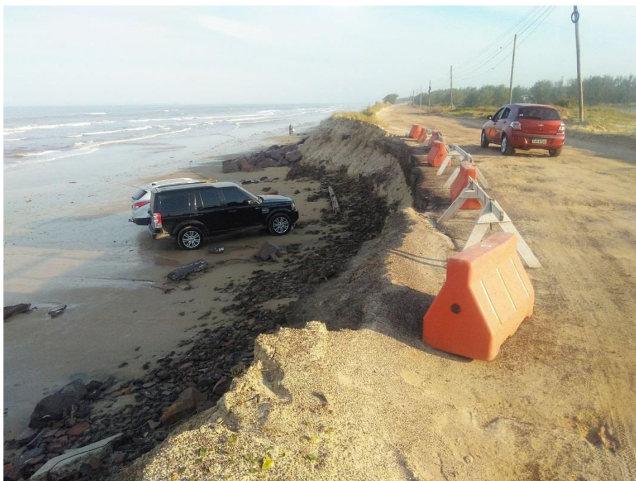
Figura 14 - Estrada interpraias trecho 0 parcialmente interrompida após evento que provocou erosão e danificação nas dunas e estrutura.
