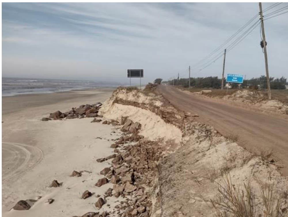
Figura 13 - Vista da praia trecho T0, limite do Balneário Atlântida Sul com Balneário Imara. Dunas erodidas e estrada danificada.
