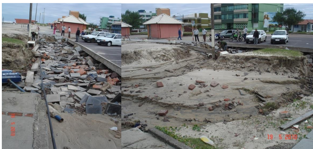
Figura 17 - Estruturas degradadas após maré de tempestade em 2010.
