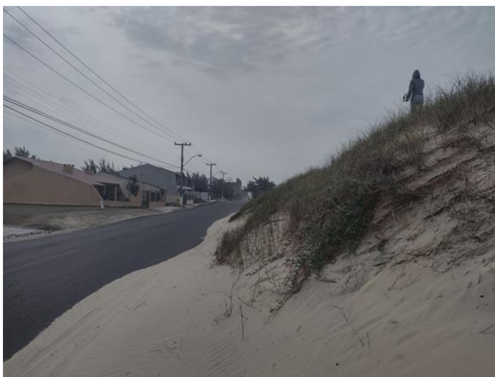
Figura 33 - Fuga de areia para o continente no trecho T9
