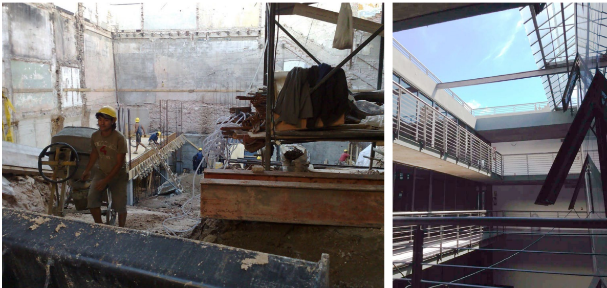
Figura 47 - Parte interna do edifício destruída e iniciam-se as construções dos subsolos. Ano: 2011. À direita, clarabóia automatizada. Fonte: En Perspectiva e InfoCasas Uruguay.
