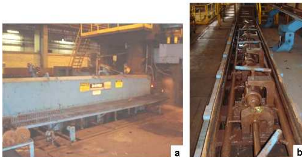
Figura 2-16 – Caixas de resfriamentos a) em linha na laminação b) parte interna.
