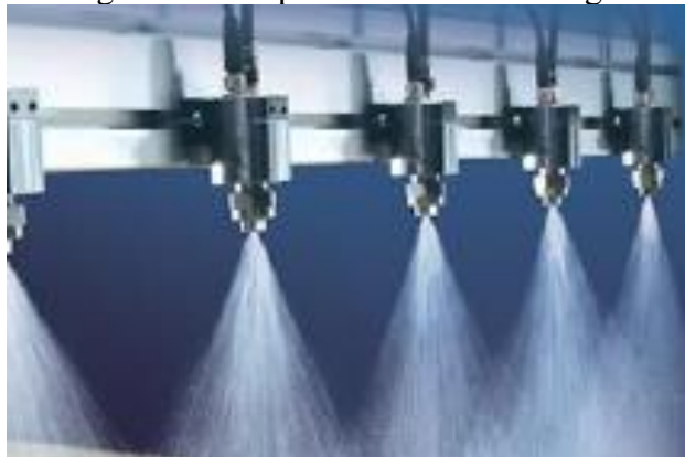
Figura 20 – Aspersores de névoa d'água
