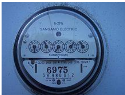
Figura 14: Medidor de energia eletromecânico.
