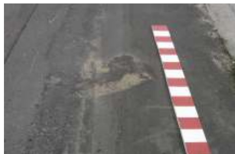
Figura 29: panela de severidade média
