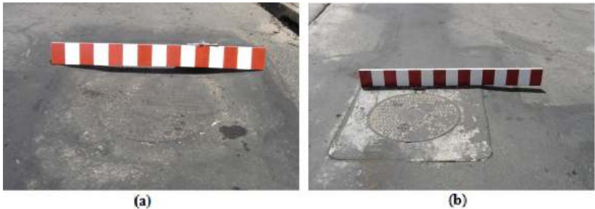
Figura 23: PV com desnivelamento de afundamento (a) e de elevação (b)
