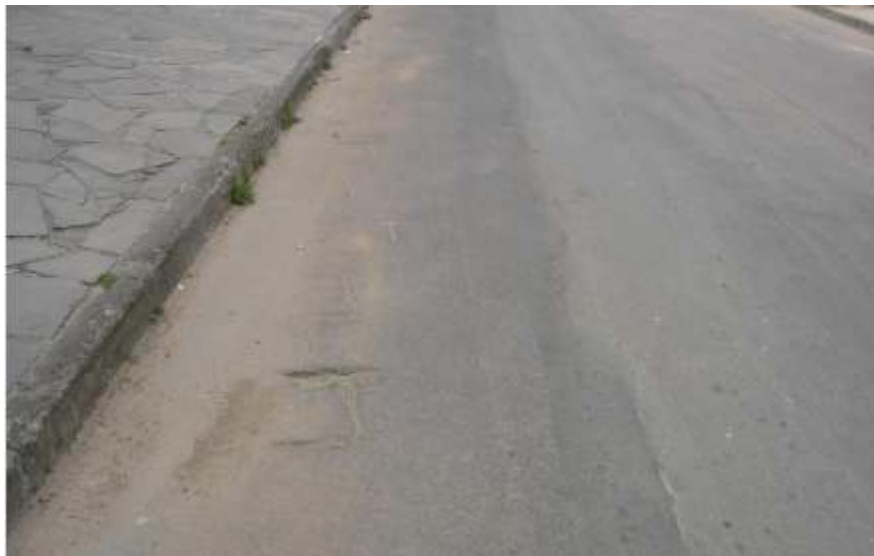
Figura 21: marcas da retroscavadeira no pavimento
