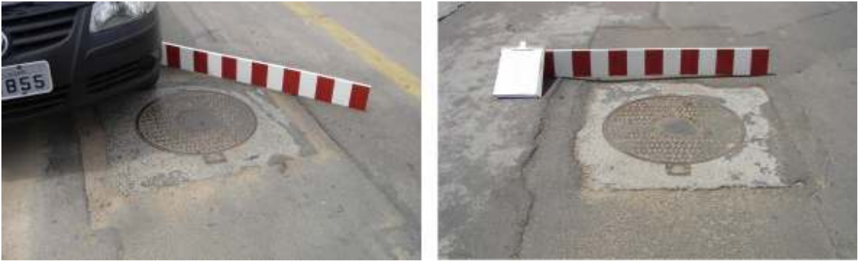
Figura 20: PV desnivelados e a tendência da repavimentação em se nivelar com o mesmo
