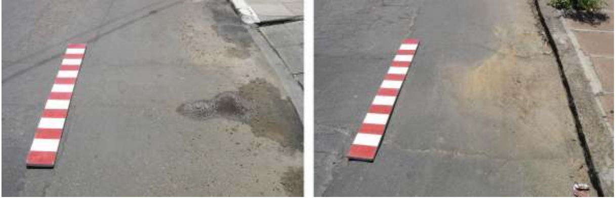
Figura 35: elevação causada pelo asfalto dos ramais
