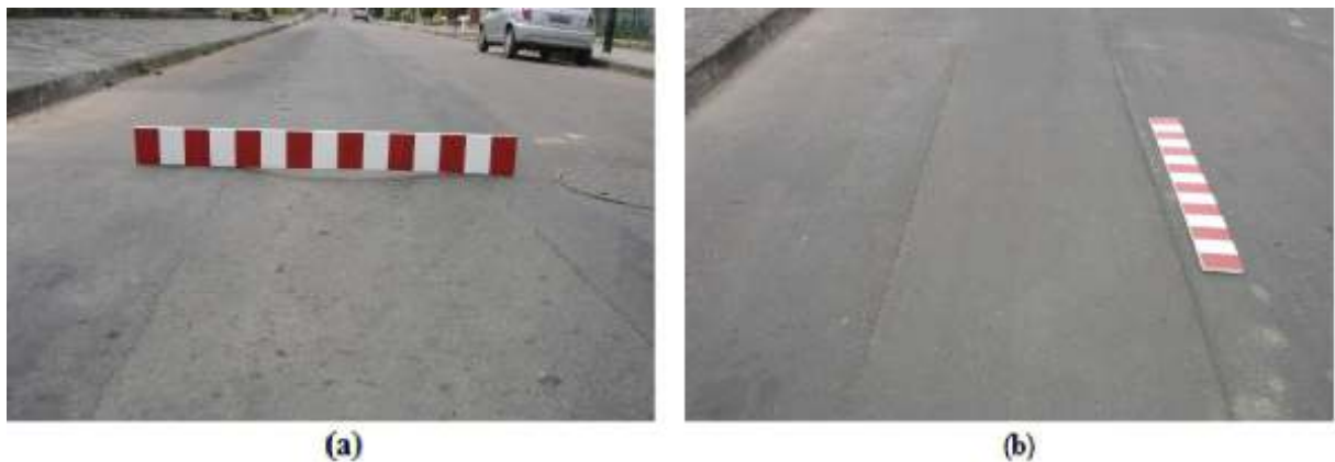
Figura 19: afundamento da repavimentação (a) e trincamento longitudinal de pavimento existente com o remendo (b)
