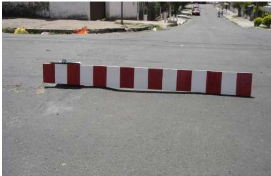
Figura 24: afundamento com solevamento lateral
