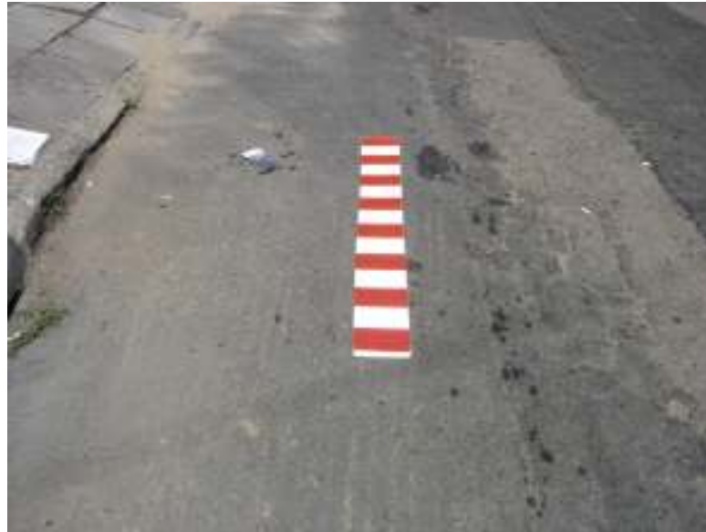
Figura 33: trincas de fadiga no pavimento existente
