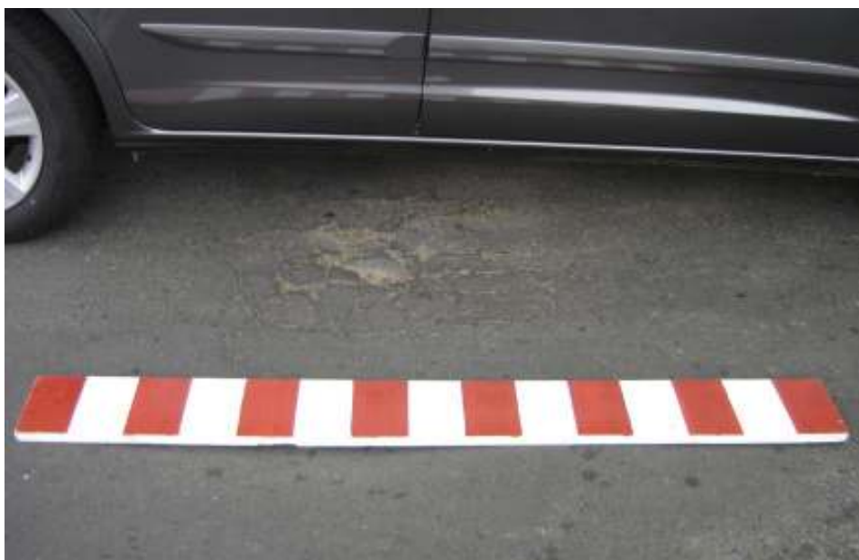
Figura 31: trinca tipo couro de jacaré
