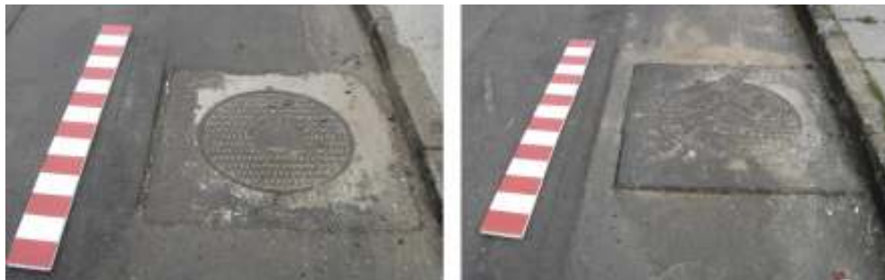
Figura 28: desnivelamento de PV e o aparecimento de trincas
