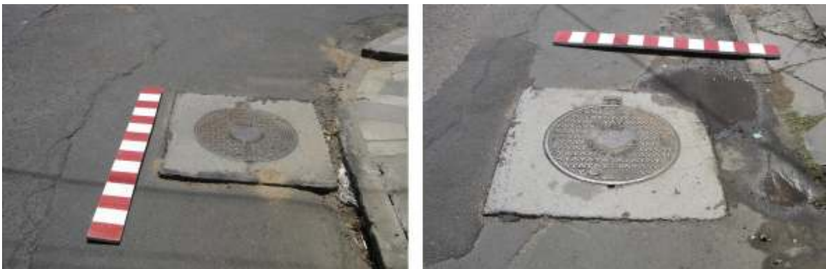
Figura 34: poço de visita desnivelado e a presença de trincas longitudinais
