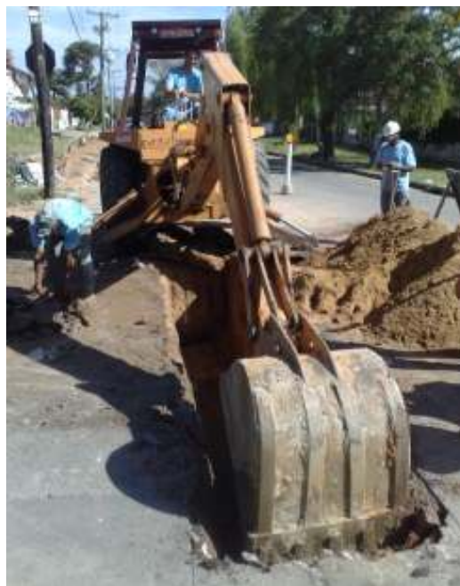
Figura 9: rompimento do pavimento
