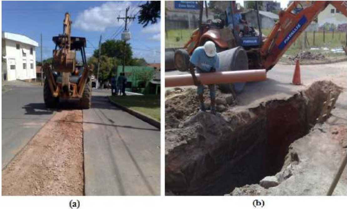
Figura 8: comparação entre remoção do pavimento asfáltico com base de brita graduada (a) e paralelepípedo (b)
