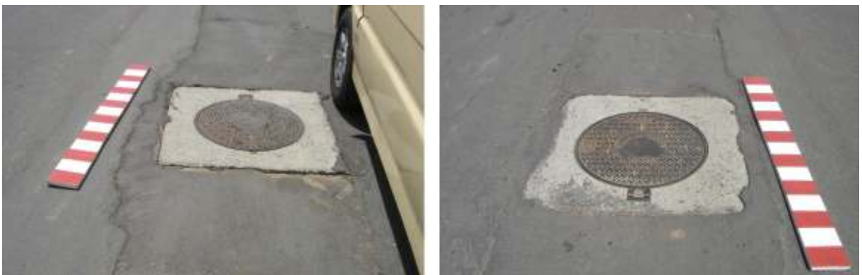
Figura 27: afundamento e falta de acabamento em torno dos PV
