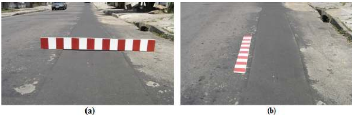
Figura 22: afundamento do remendo (a) causando trincas longitudinais com pavimento existente (b)
