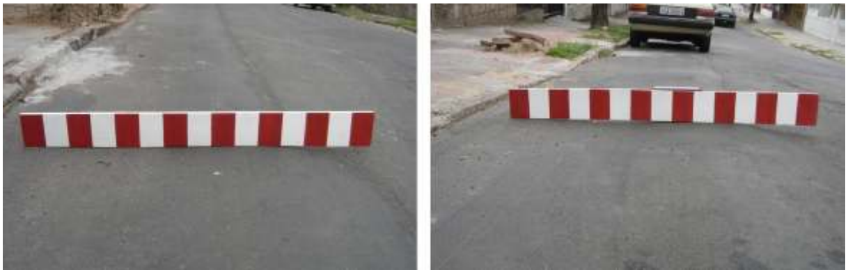
Figura 30: elevação de remendos
