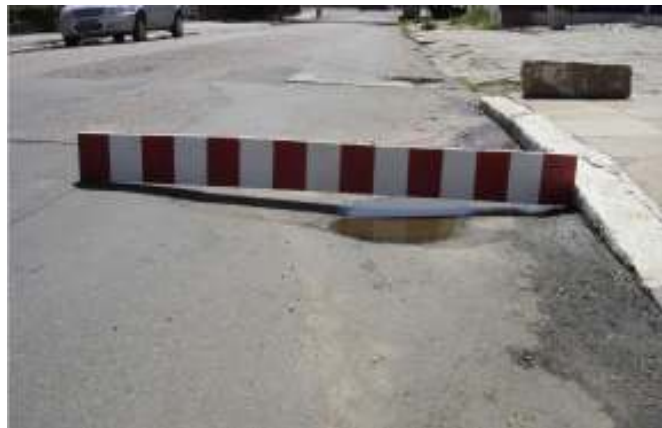
Figura 36: afundamento criando ondulações na repavimentação
