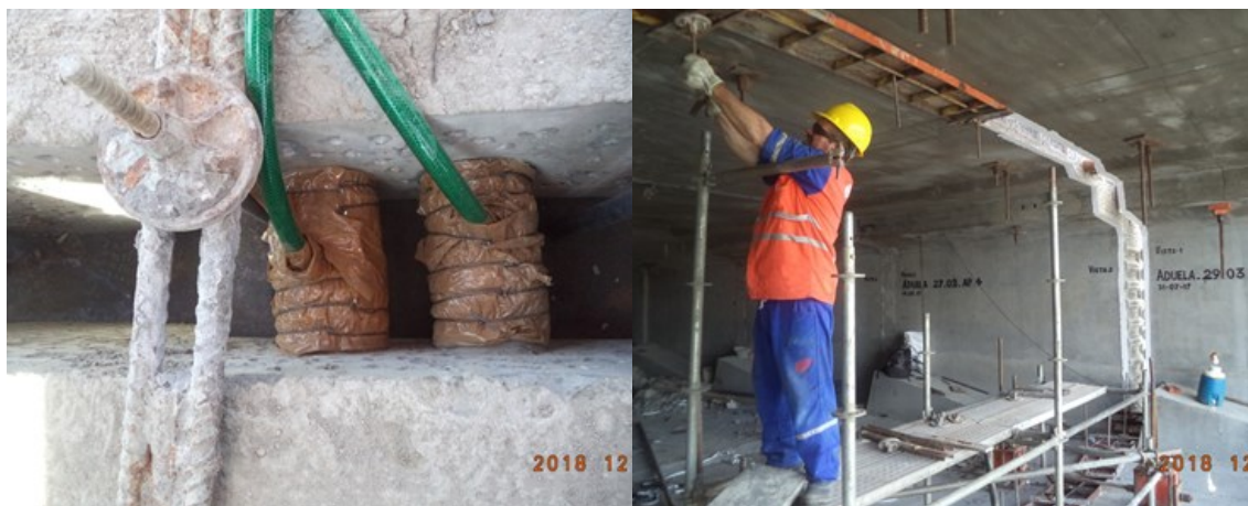
Figura 6.17 – Junta entre aduela: a) armadura ativa passando pela junta; b) concretagem da junta
