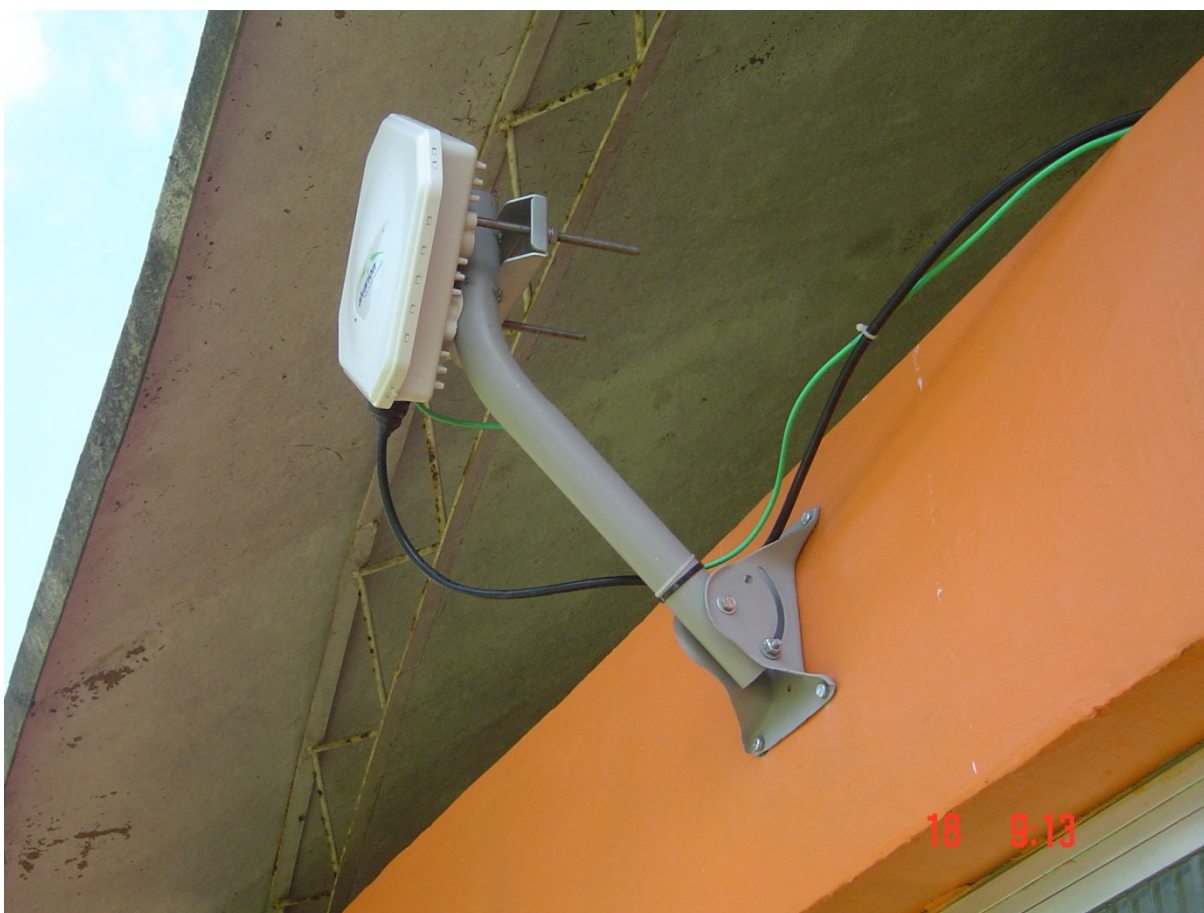
Figura 4.2 - Instalação de uma unidade de assinante (antena integrada ao rádio)
