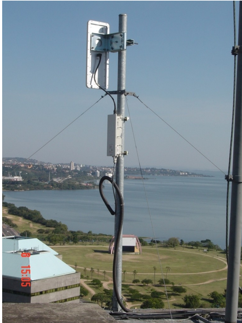
Figura 4.4 - Instalação típica de uma unidade de acesso com antena setorial.
