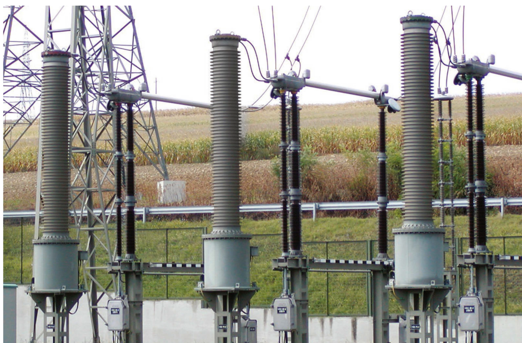
Figura 10 – Transformador de potencial de uma subestação.
