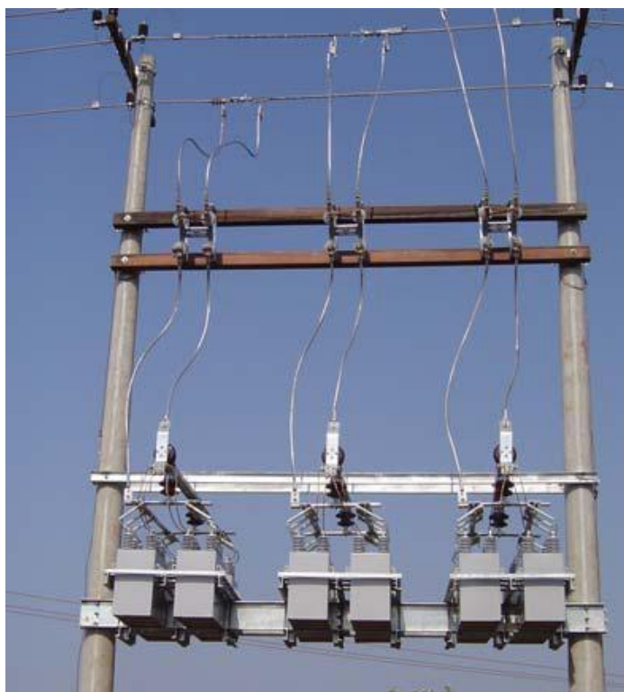
Figura 14 – Banco de capacitores em série.
