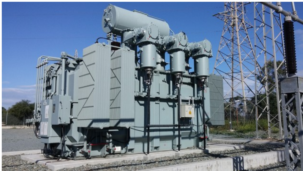
Figura 15 – Reator em derivação da fabricante Siemens .
