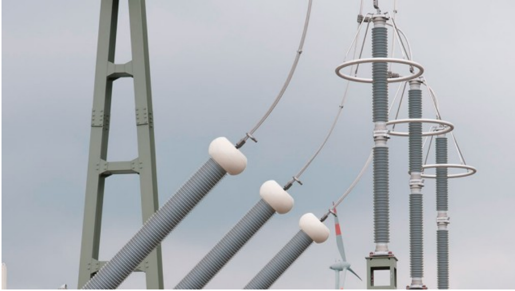
Figura 16 – Para-raios da fabricante Siemens .
