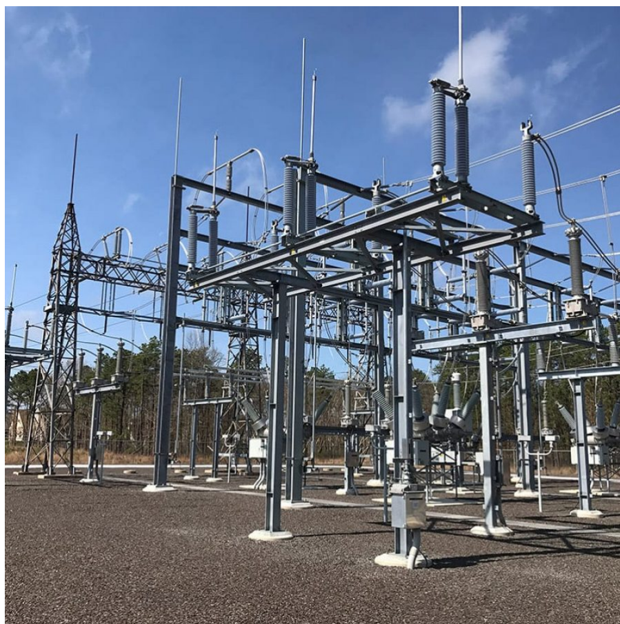
Figura 12 – Chave seccionadora de uma subestação.
