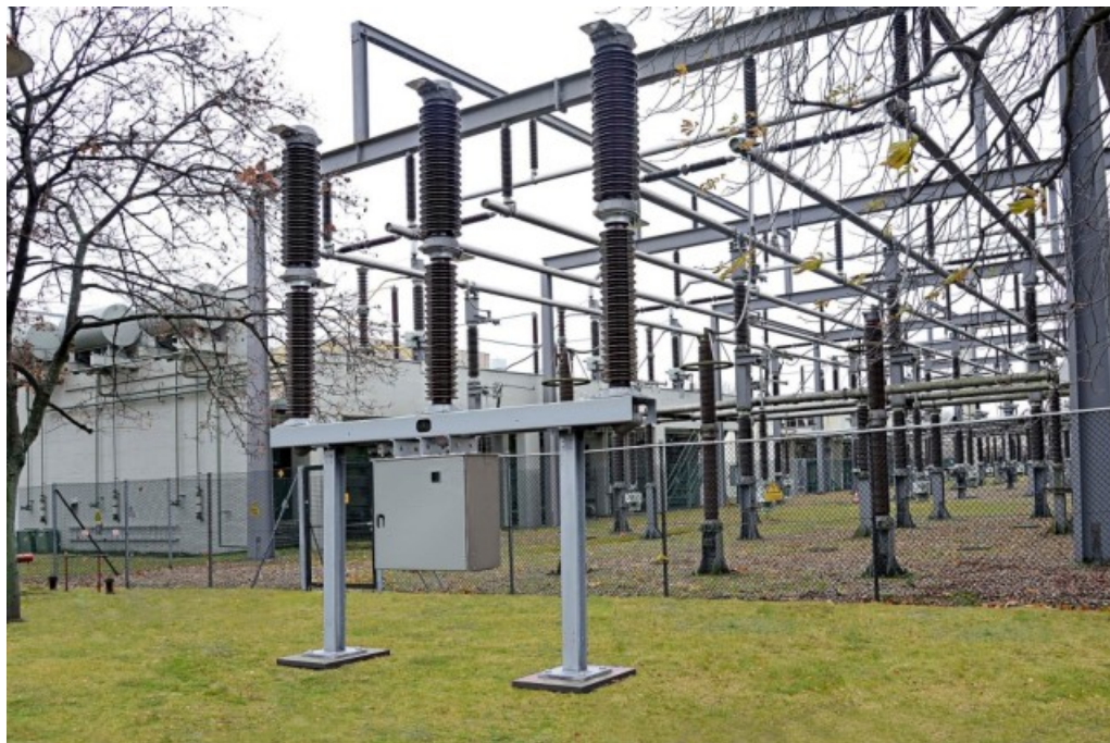
Figura 11 – Disjuntor de alta tensão.
