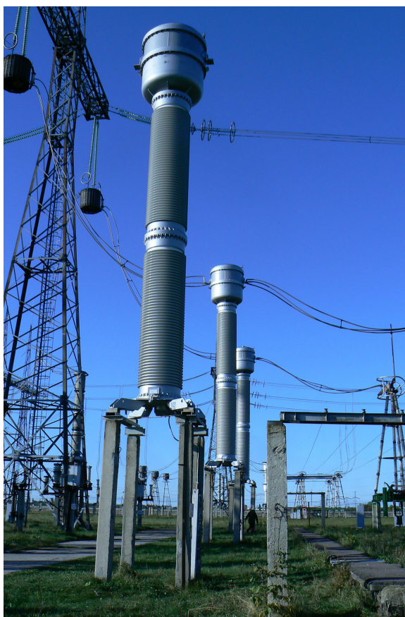
Figura 9 – Transformador de corrente de uma subestação.
