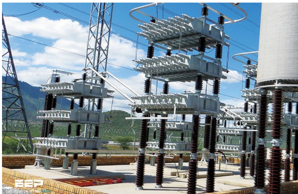
Figura 13 – Banco de capacitores em derivação.
