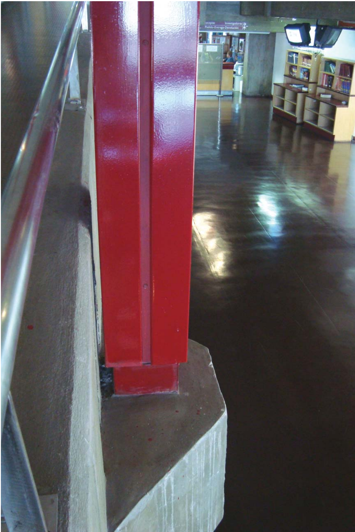
Fig. 81. Tensores para sustentação da rampa da Sala de Leitura. Biblioteca Nacional. (Fonte: Acervo da autora, Maio 2009.)
